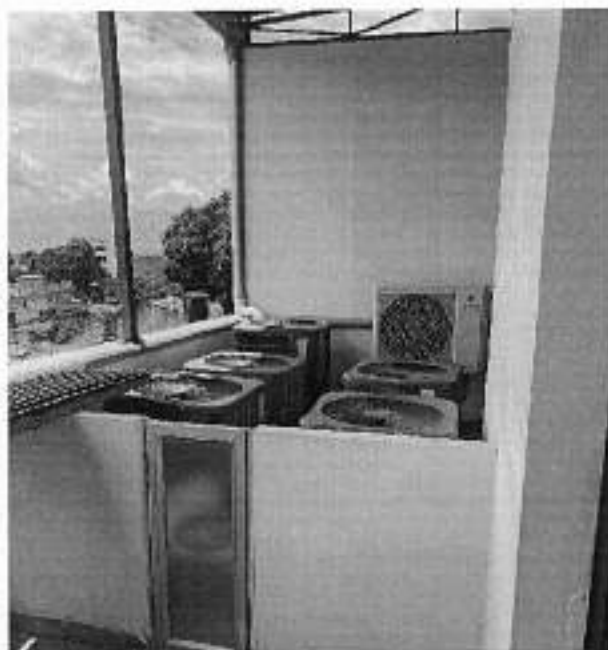
Ilustración No. 019 Sistema de equipos condensadoras.
