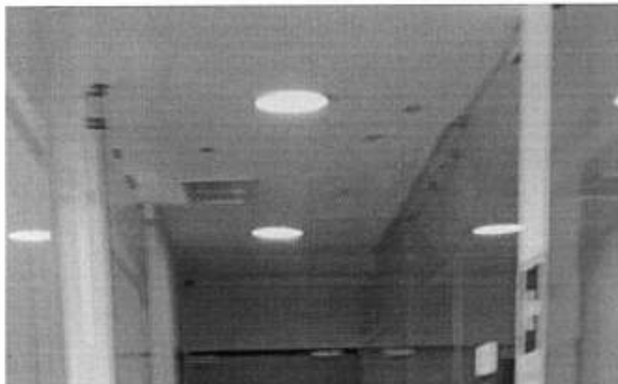
Ilustración No. 021 Sistema de iluminación en Panel Led.
