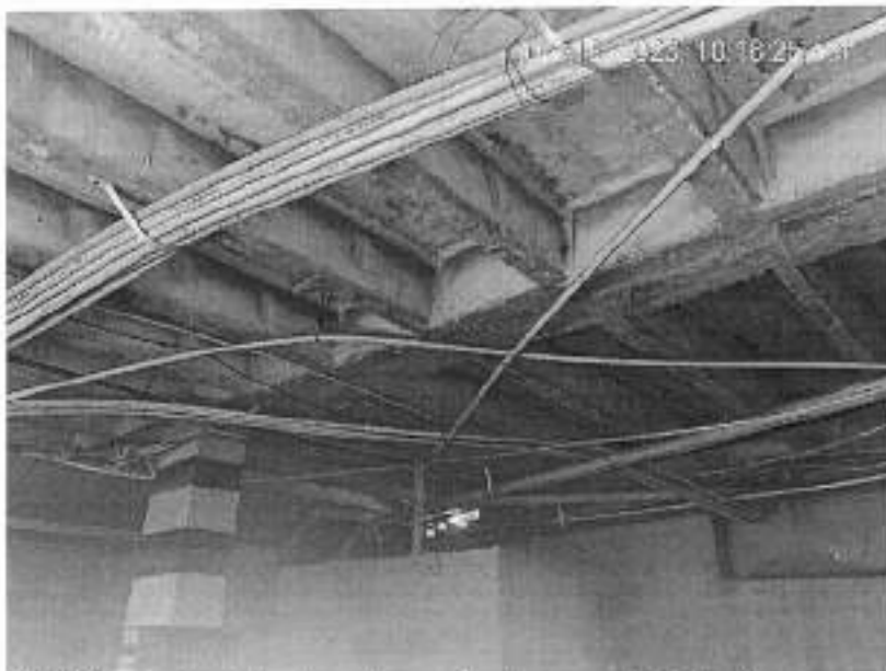
Ilustración No. 023 Sistema de cableado mal organizado en su distribución.
