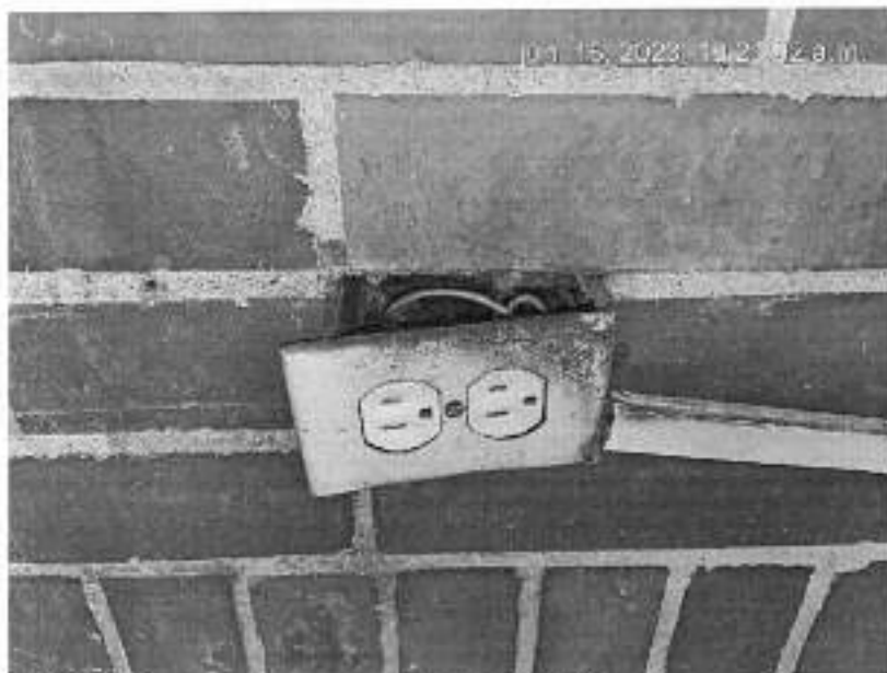
Ilustración No. 019 Deterioro en sistemas y cableado eléctrico.
