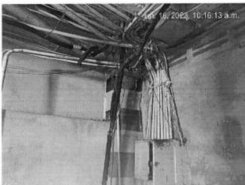
Ilustración No. 022 Sistema de cableado mal organizado en su distribución.
