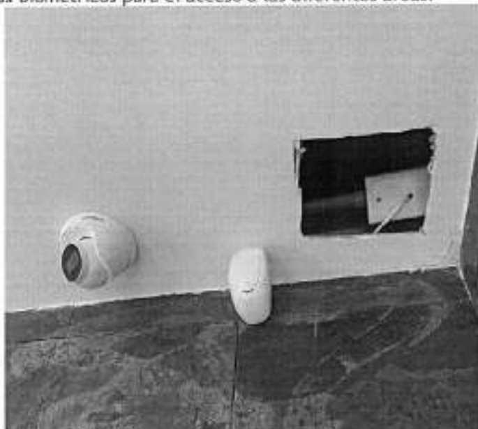
Ilustración No. 022 Sistema de CCTV.
