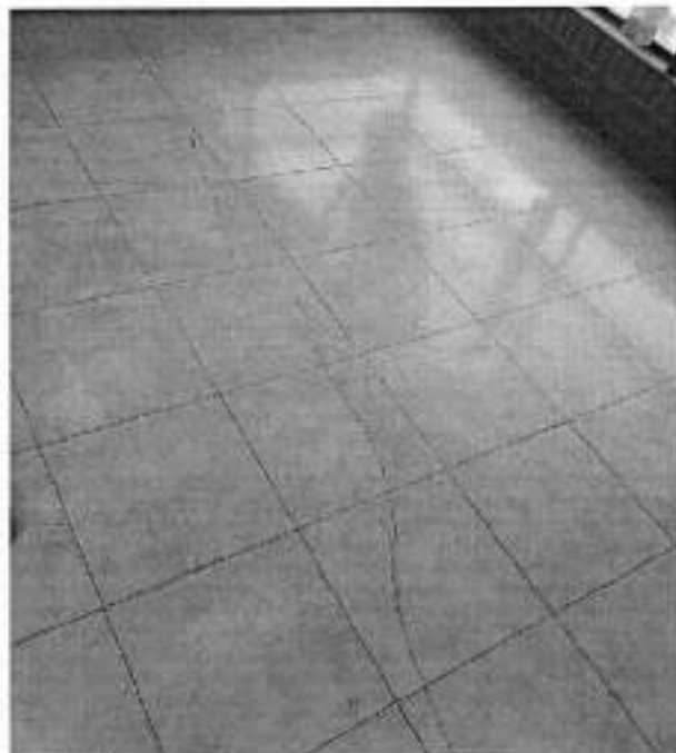
Ilustración No. 016 Fisuras en pisos.
