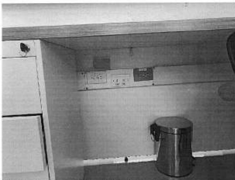
Ilustración No. 014 Red eléctrica normal, regulada, voz y dato.
