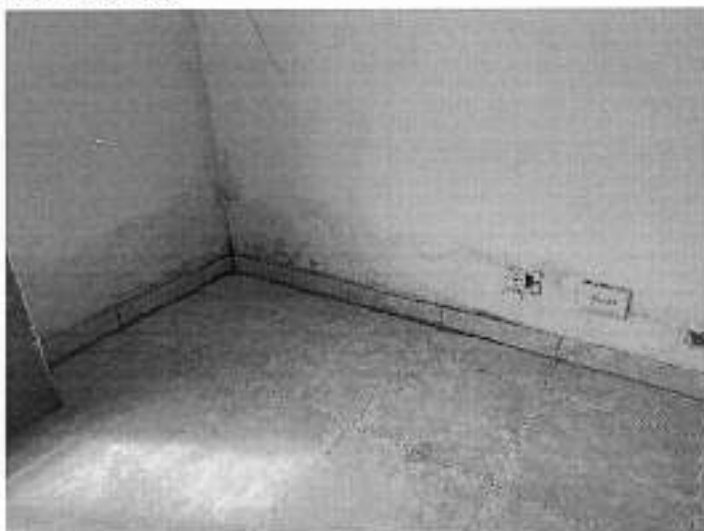
Ilustración No. 008 Presencia de humedades en muros.
