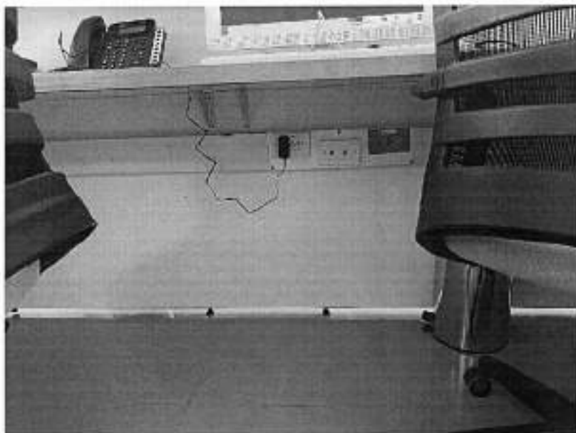
Ilustración No. 013 Red eléctrica normal, regulada, voz y dato.
