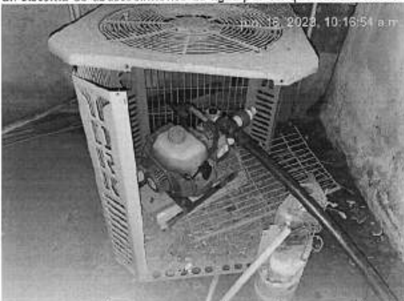
Ilustración No. 030 La edificación cuenta con un sistema de almacenamiento de agua (tanque subterráneo) conectado a la red pluvial para suministrar en caso que el suministro sea interrumpido. Bomba no operativa.
