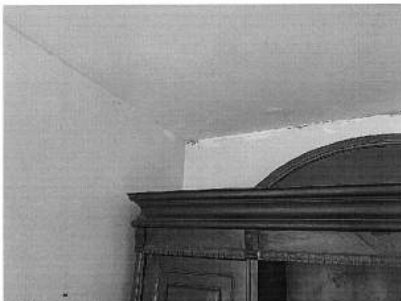
Ilustración No. 007 Mal acabados en pintura en muros.
