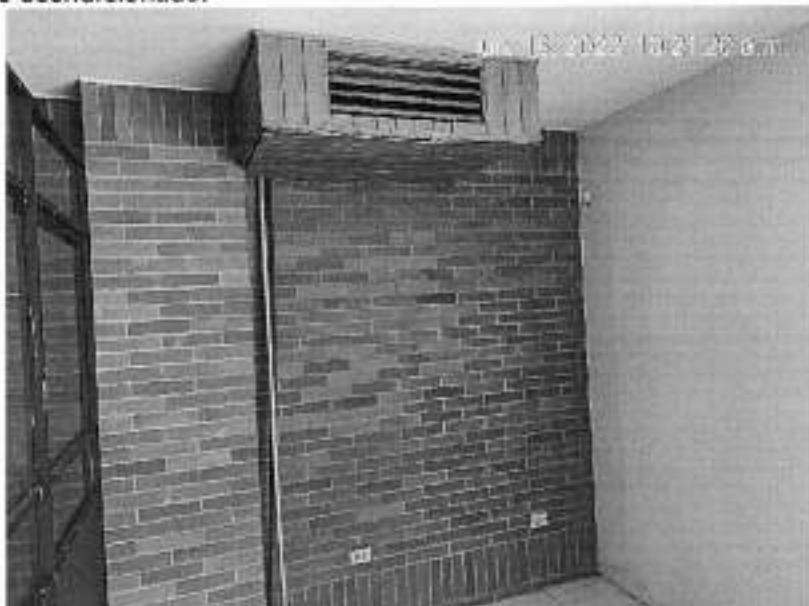
Ilustración No. 024 La edificación cuenta con un sistema de aire central el cual no está en funcionamiento, solo cuenta con el sistema de rejillas de salida y sistema de ductos.
