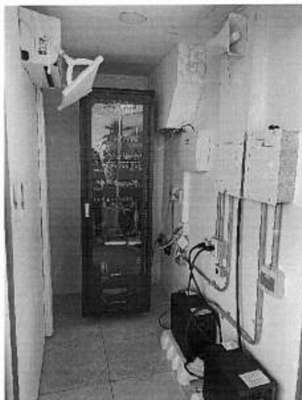
Ilustración No. 015 Cuartos Eléctrico y Rack por cada piso.
