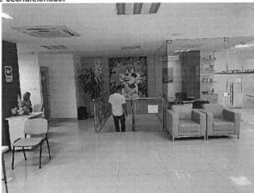
Ilustración No. 016 La edificación cuenta con un sistema de aire tipo VRF y sistema mini Split.
