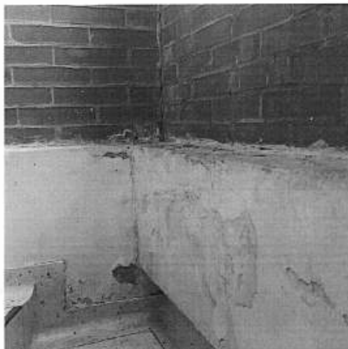
Ilustración No. 010 Presencia de humedades en muros.
