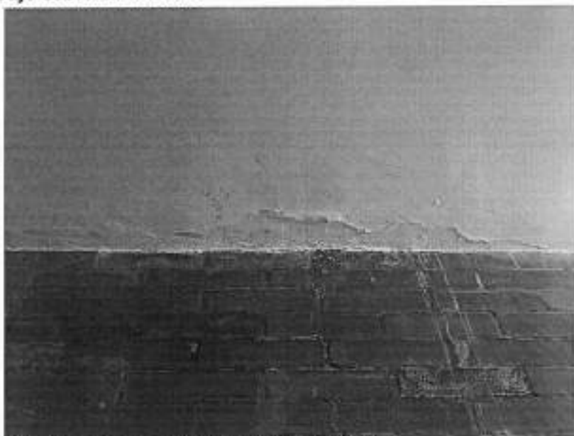
Ilustración No. 011 Humedades y desprendimiento de pintura.
