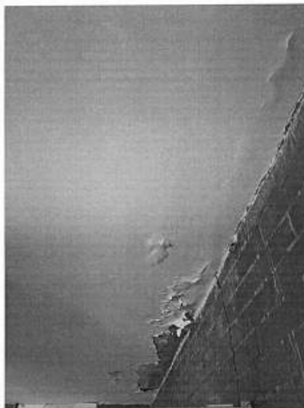
Ilustración No. 013 Humedades y desprendimiento de pintura.
