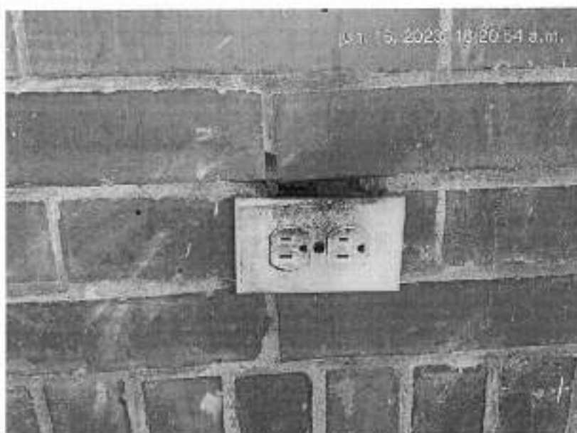
Ilustración No. 020 Deterioro en sistemas y cableado eléctrico.
