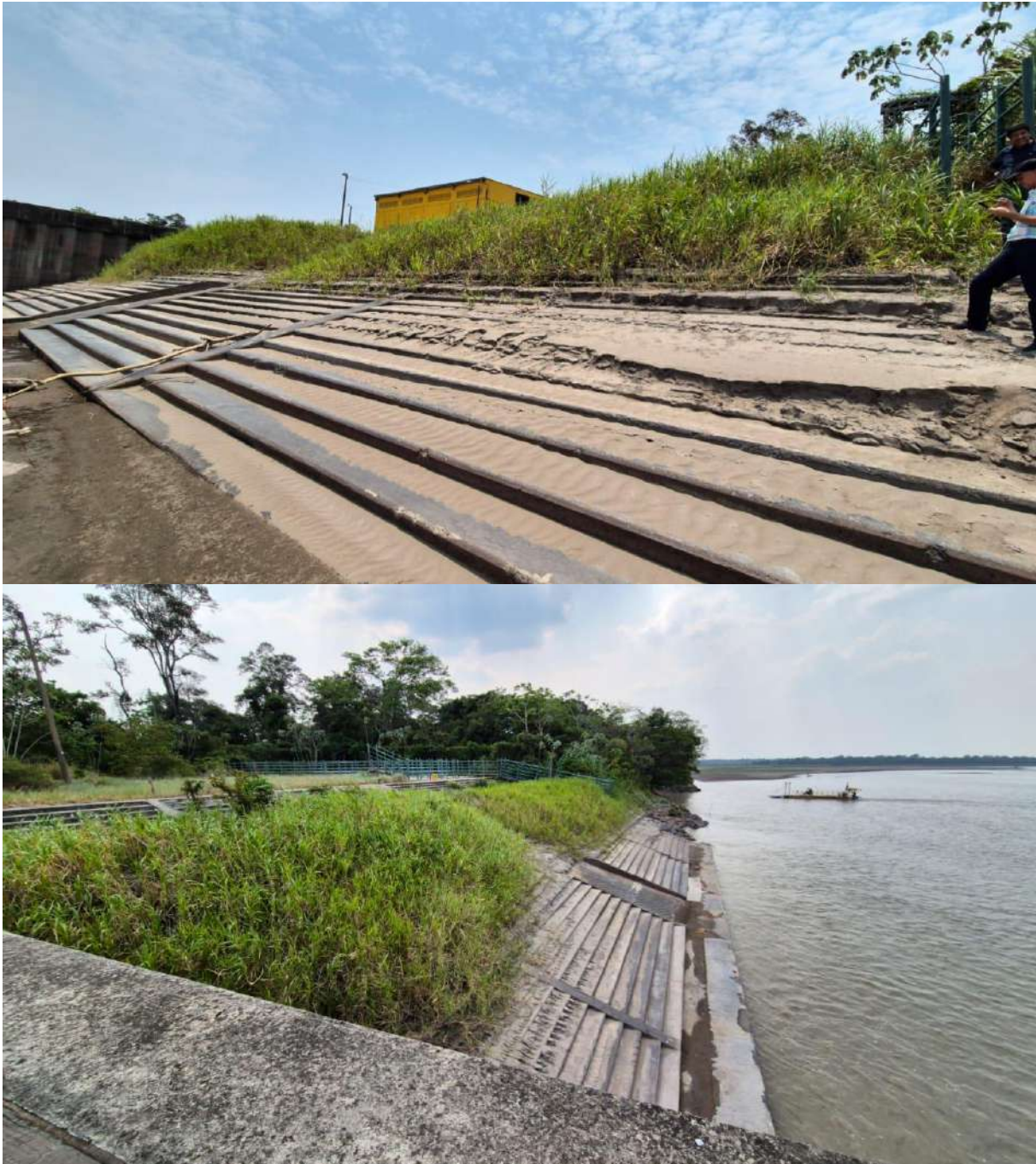
Fotografía No. 3. Muelle de pasajeros con un proceso de colmatación avanzado que llevó a la pérdida de las gradas y su operatividad. Requiere limpieza y retiro de sedimentos para volver a ponerlo en operación.
