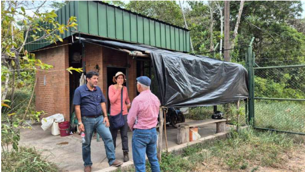
Fotografía No. 8. Estado de caseta de vigilancia
