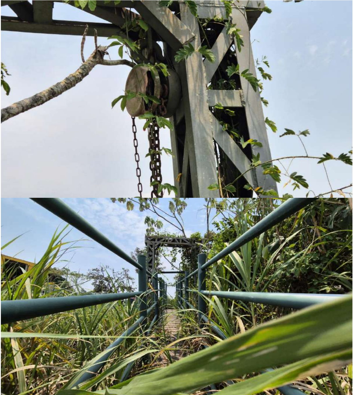
Fotografía No. 2. Pasarela del muelle para descarga de animales, y detalle de diferencial en mal estado.
