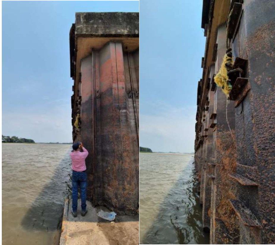
Fotografía No. 4. Algunos elementos de protección como madera y elementos metálicos muestran deterioro o pérdida.
