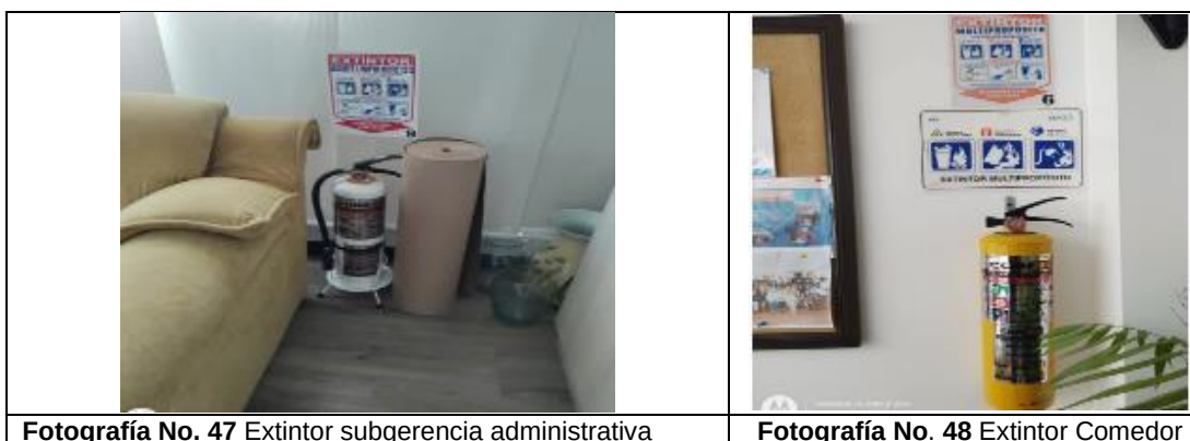
Fotografía No. 47 Extintor subgerencia administrativa
