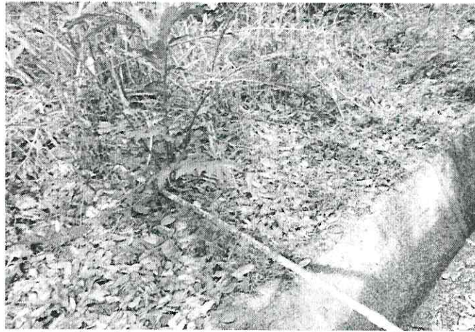
Tubería de conducción al tanque elevado cubierta por material orgánico vegetal
