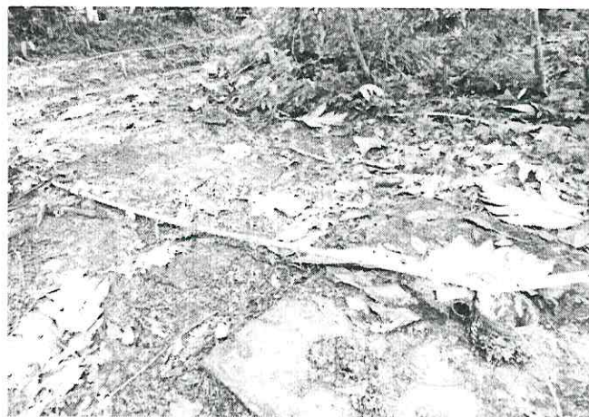
Lodo circulante por efectos de la escorrentía con riesgo de penetrar por juntas al interior de la tubería de conducción
