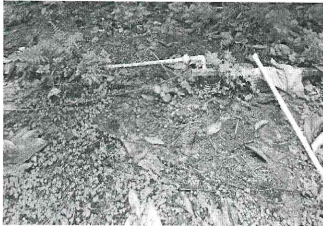
Punto de partida de la línea de conducción en PVC de 1 pulgada en igual condicione de riesgo
