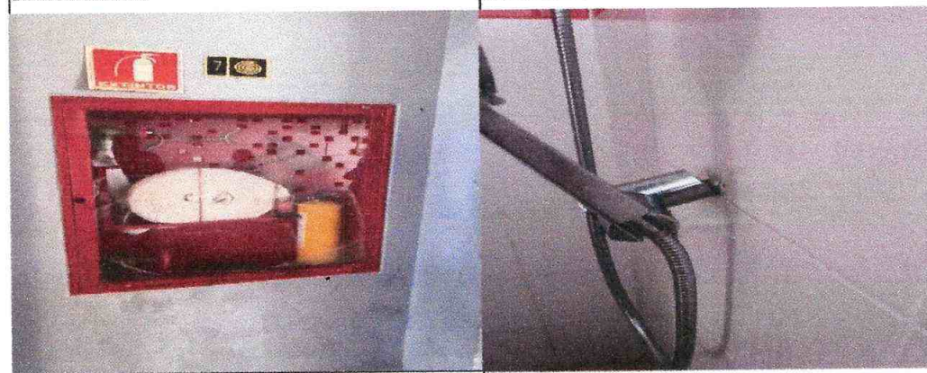
PUNTO CONTRA INCENDIOS
