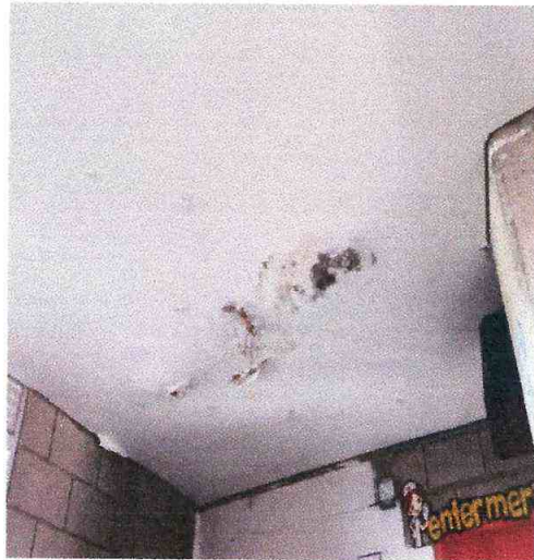
Humedades en placas flotante.
