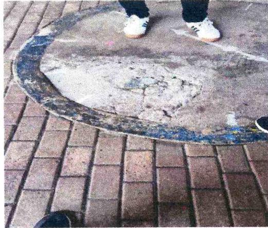
Pisos en mal estado
