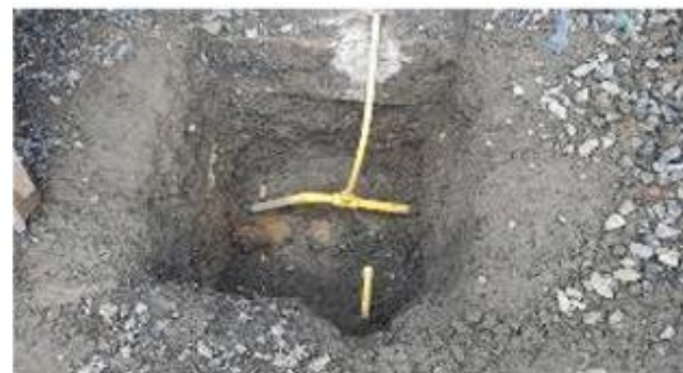
FOTO 32. Conexión acometida red de gas sector Espacio Óptimo
