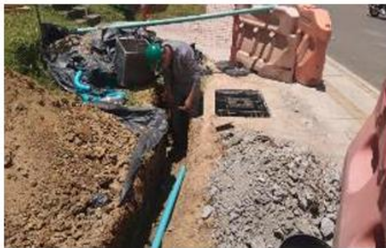
Foto 3: Red eléctrica para semáforos calle 60
