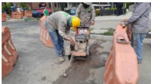
FOTO 75. Cruce de redes eléctricas calle 56 sur
