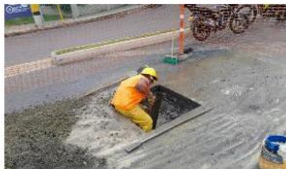
FOTO 21. Reparación de daño en red de acueducto ID 87 por parte de EPM
