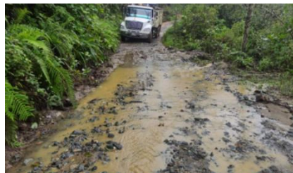
Acceso deteriorado Tumburao
