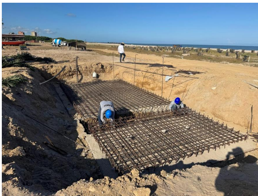
Acero estructural tanque
