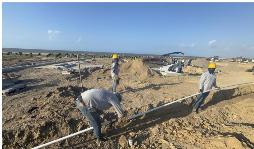
Tubería agua potable
