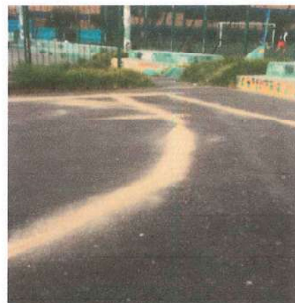
Foto No. 2- Sello Fisuras Cancha Baloncesto
