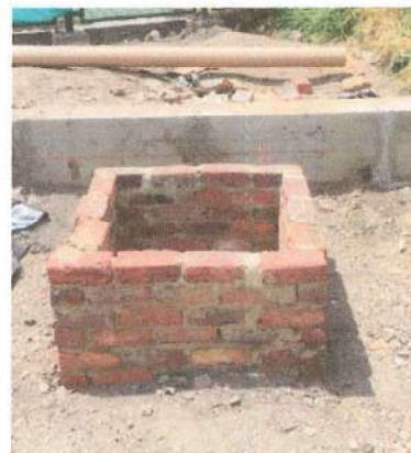
Foto No. 4- Caja Electrica CS274
