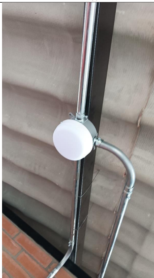
ILUMINACION TIPO PANEL
