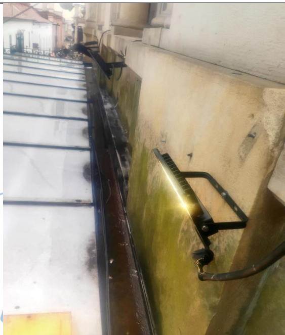
Ilustración 42. Mant. Iluminación Marquesina
