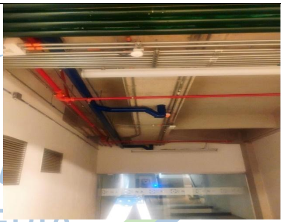
Ilustración 64. Mant. Sensores de presencia ST1
