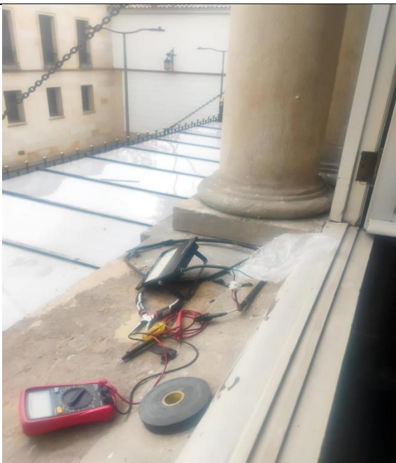
Ilustración 41. Mant. Iluminación Marquesina
