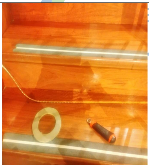
Ilustración 29. Mant. Cinta led galería
