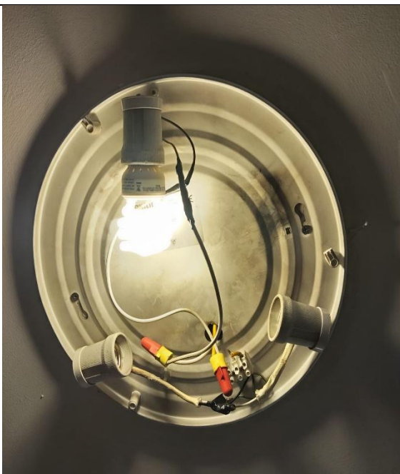
Ilustración 35. Mant. Apliques de techo P2
