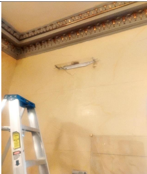
Ilustración 9. Mant. Iluminación entrada
