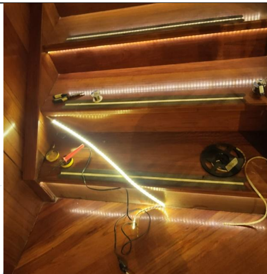
Ilustración 28. Mant. Cinta led galería
