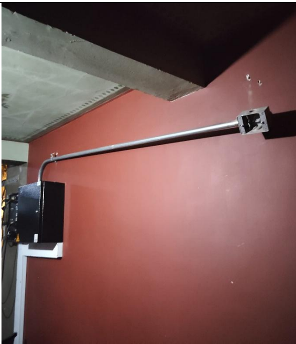
Ilustración 23. Mant. Iluminación Avanced
