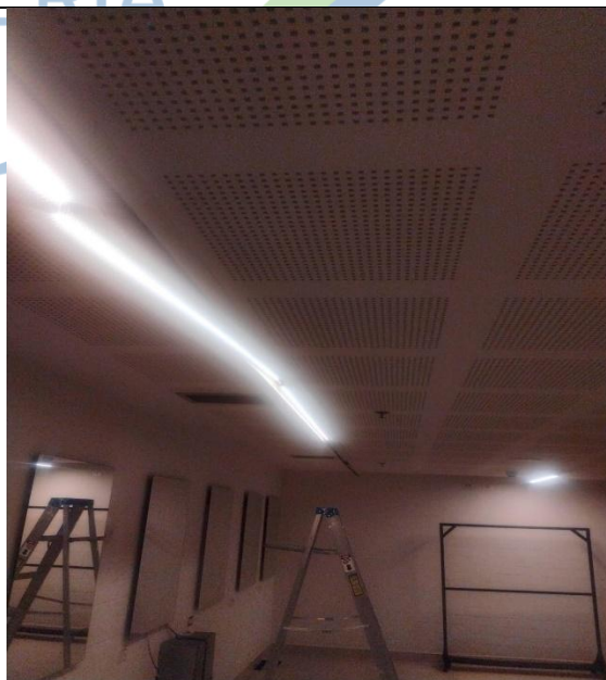
Ilustración 78. Mant. Luminaria lineal ST3
