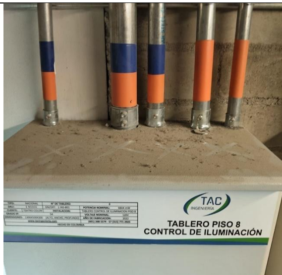
Ilustración 59. Limpieza Tableros de iluminación P1
