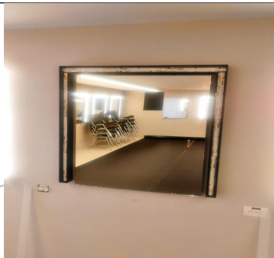
Ilustración 130. Mant. Luminaria espejos P5
