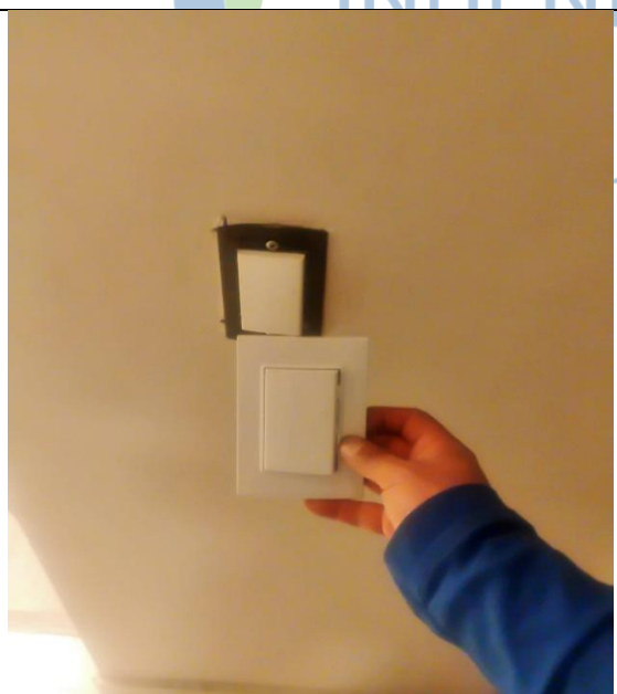
Ilustración 71. Mant. Botoneras de iluminación ST4
