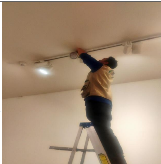
Ilustración 14. Mant. Riel piso 1
