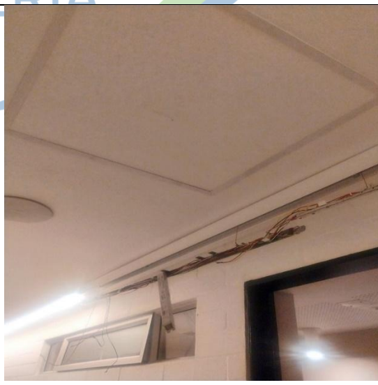
Ilustración 82. Mant. Luminaria lineal ST3
