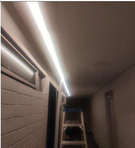
Ilustración 83. Mant. Luminaria lineal ST3
