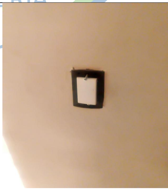
Ilustración 72. Mant. Botoneras de iluminación ST4
