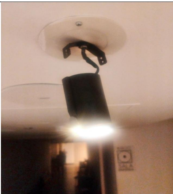
Ilustración 115. Mant. Luminaria cilíndrica P6
