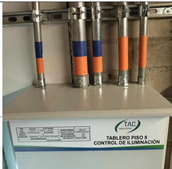
Ilustración 60. Limpieza Tableros de iluminación P1
