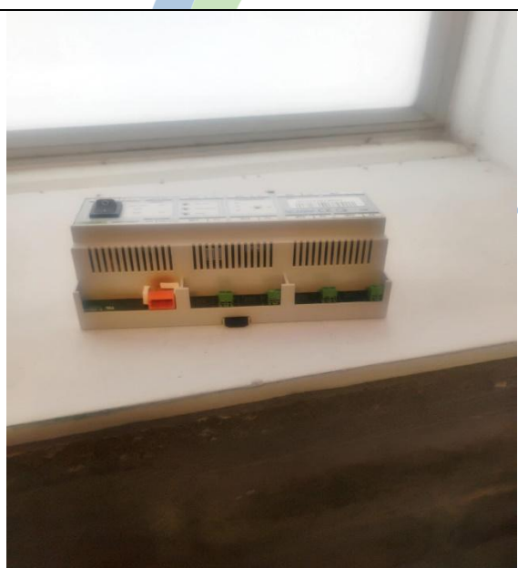
Ilustración 61. Controlador en daño P8
