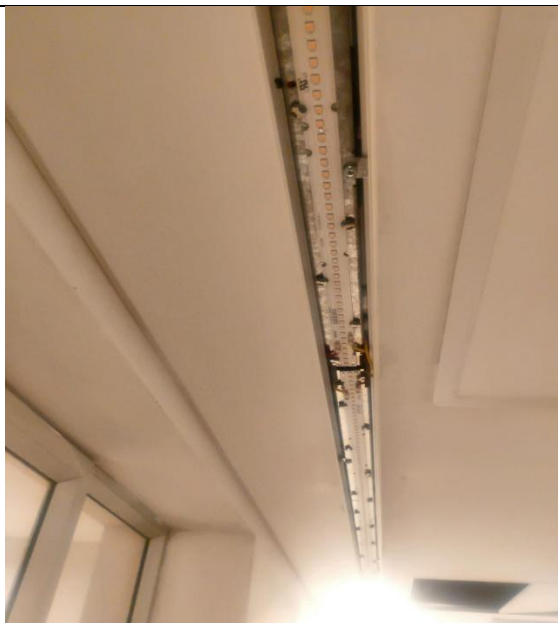
Ilustración 75. Mant. Luminaria lineal ST3
