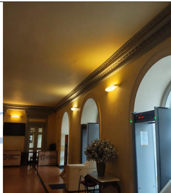
Ilustración 10. Mant. Iluminación entrada
