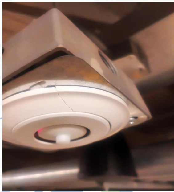
Ilustración 68. Mant. Sensores de presencia ST2
