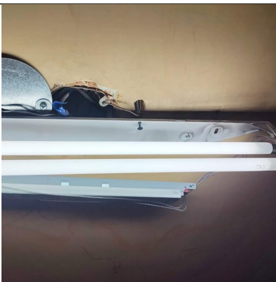
Ilustración 7. Mant. Iluminación entrada
