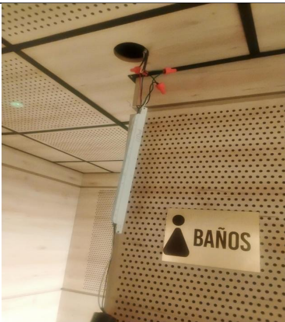
Ilustración 111. Mant. Luminaria bala ST4
