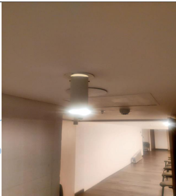
Ilustración 116., Mant. Luminaria cilíndrica P6
