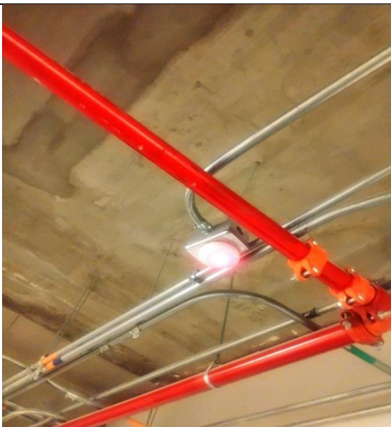
Ilustración 67. Mant. Sensores de presencia ST2
