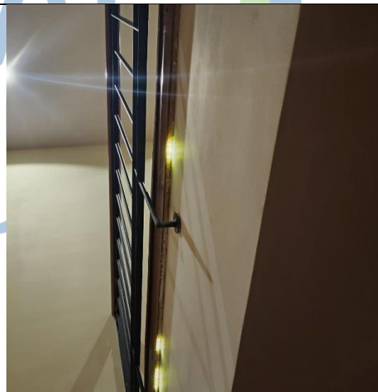
Ilustración 26. Mant. Cinta led ingreso galería
