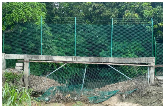
Ilustración 5 Estado Actual del Cerramiento en el Aeropuerto
