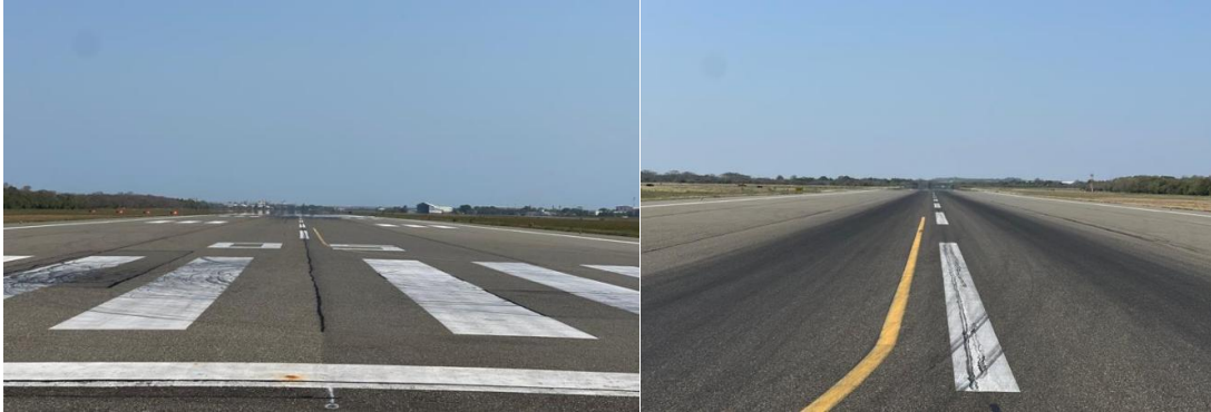
Ilustración 6 Estado Actual del Pavimento Asfáltico del Aeropuerto
