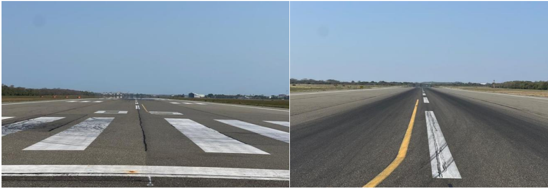
Ilustración 6 Estado Actual del Pavimento Asfáltico del Aeropuerto
