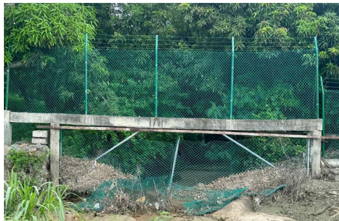
Ilustración 5 Estado Actual del Cerramiento en el Aeropuerto
