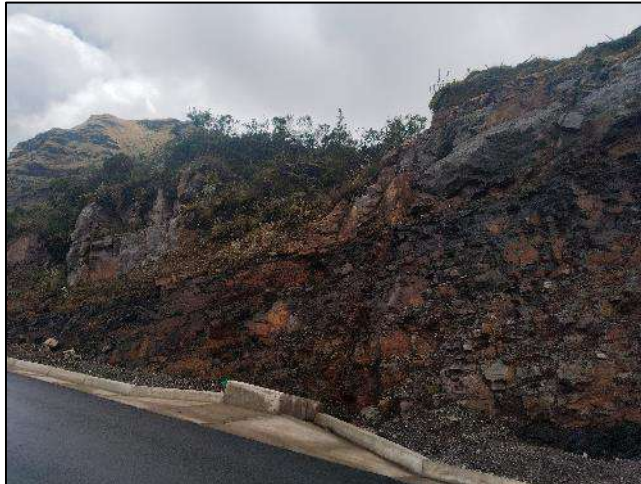
Vista general de los taludes de corte del PR59+050-PR59+500 de la Ruta 6404. Se observan fuertemente meteorizados y diaclasados. Fotografía 7 Sector del PR59+050-PR59+500 Ruta 6404.
