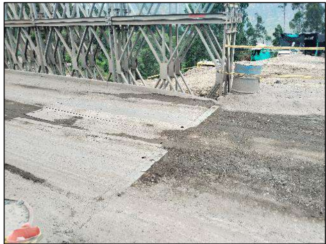
En el estribo Paz del Río se formaban abultamientos en la estructura del pavimento, con la implementación de la cimentación profunda, durante la inspección geológico-geotécnica esta patología no se identificó.
