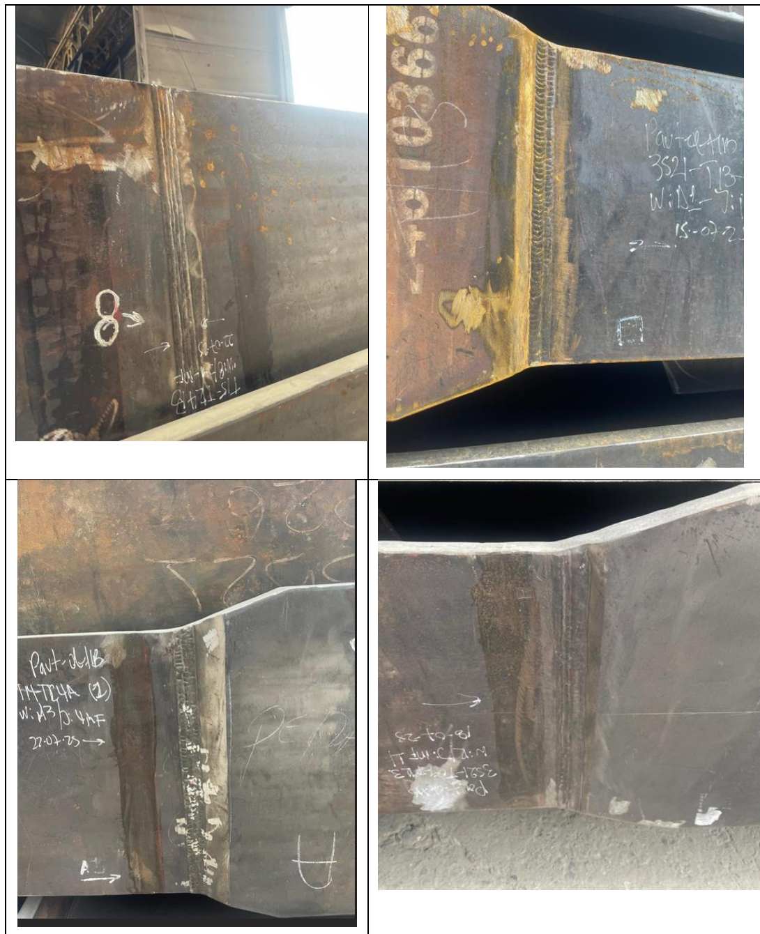
Figura 2. Soldaduras en el alma y aletas de las vigas
