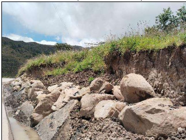
Desprendimientos de materiales térreos, caídas de bloques de roca y de detritos de la cara de los taludes de corte (PR51+100-PR51+300).
