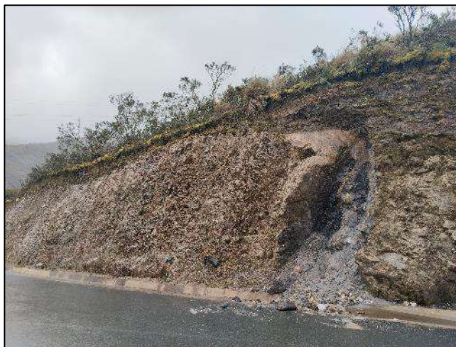
Cárcavas de erosión en los taludes de corte.
