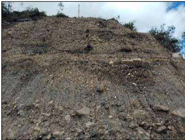
Surcos de erosión en la cara de los taludes de corte en el sector del PR51+600.
