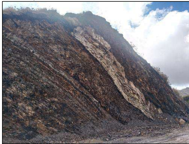
Talud de corte fuertemente fracturado y diaclasado, carece de cobertura vegetal así como de obras de control de agua de escorrentía superficial y de infiltración.
