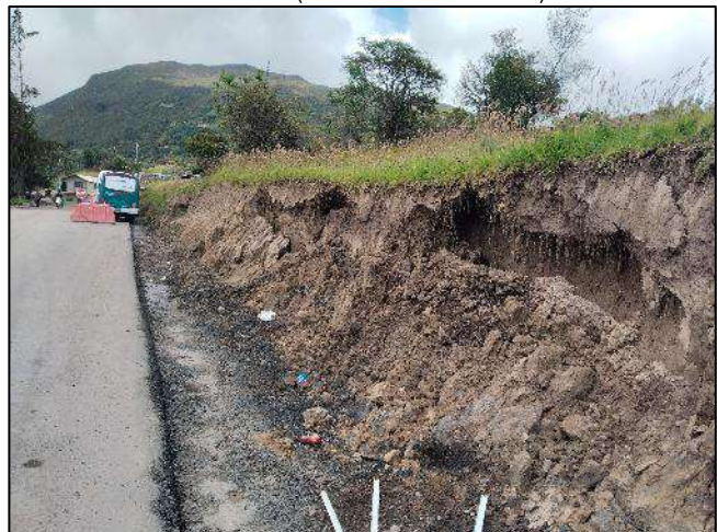
Presencia de cárcavas y surcos de erosión por la ausencia de cobertura superficial en la cara de los taludes (PR51+100-PR51+300).
