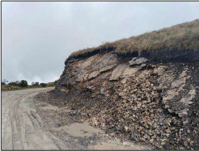
Talud de corte fuertemente fracturado y diaclasado.
