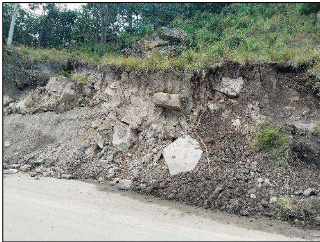
Desarrollo de procesos erosivos, caídas de bloques de roca y de detritos de la cara de los taludes de corte ejecutados por el Contratista (PR49+660-PR50+200).
