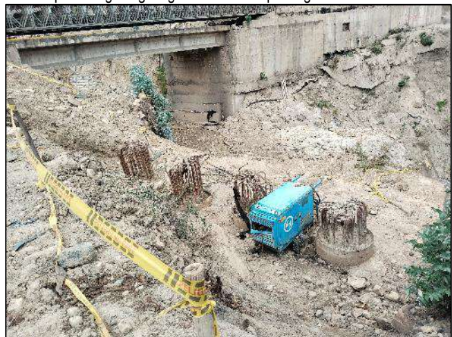
Apoyo intermedio del nuevo puente vehicular proyectado sobre la quebrada "El Boche" – costado Socha. Se apreció en buenas condiciones de estabilidad geotécnica aunque los taludes se ven afectados por erosión.
