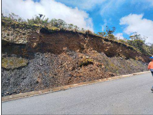
Fotografía 8. El talud se reconoció saturado y con presencia de nivel freático en su pata.
