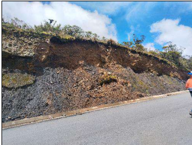
Fotografía 8 Sector del PR59+650 de la Ruta 6404. Se observa la formación de cárcavas de erosión en la corona del mismo.
