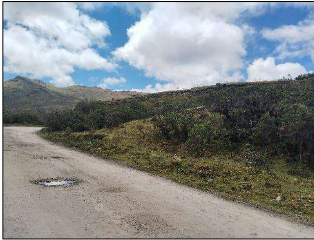
Fotografía 11 Sector del PR72+000 de la Ruta 6404.
