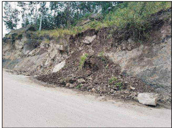
Desarrollo de procesos erosivos, caídas de bloque de roca y de detritos de la cara de los taludes de corte ejecutados por el Contratista (PR49+660-PR50+200).
