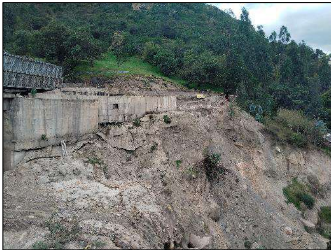
Erosión superficial en los taludes de la margen Paz del Río de la quebrada "El Boche".
