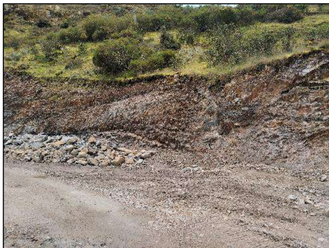
Caída de rocas de los taludes de corte.
