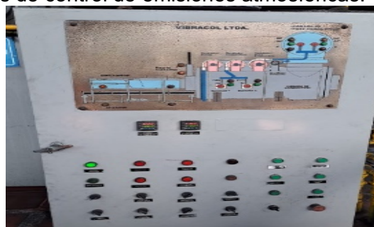
Fotografía 3. Sistema de monitoreo de temperaturas
