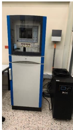
Figura 2. UPS de 6 kVA y panel de control de las máquinas.
