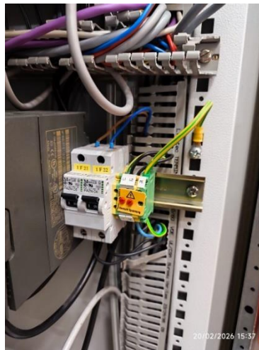
Figura 3. Breaker del panel de control de las máquinas.
