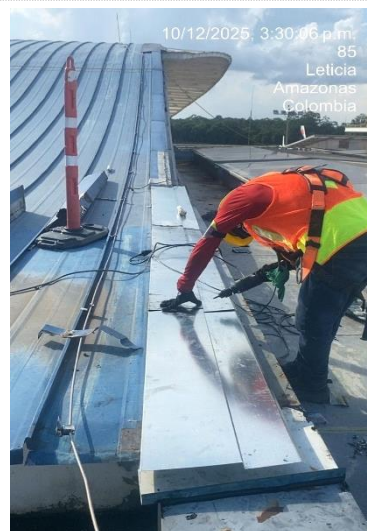
S.I de flanches metálicos, cubiertas M2
