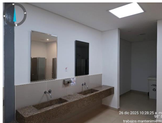
Estado actual baños piso 1 administración
