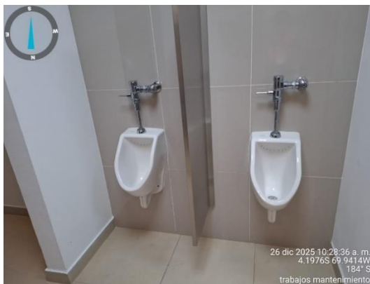
Mantenimiento orinales zona administrativa piso 1
