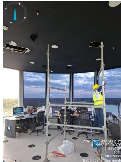
Corrección filtraciones ALL cabina controladores
