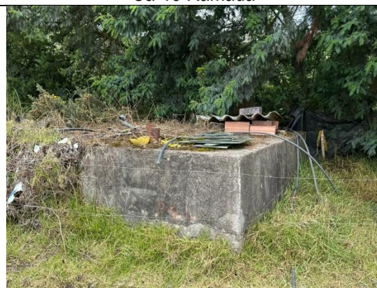
Ca-15 Tanque de agua
