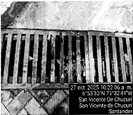
Imagen N. 1. Evidencia sistema de drenaje.
