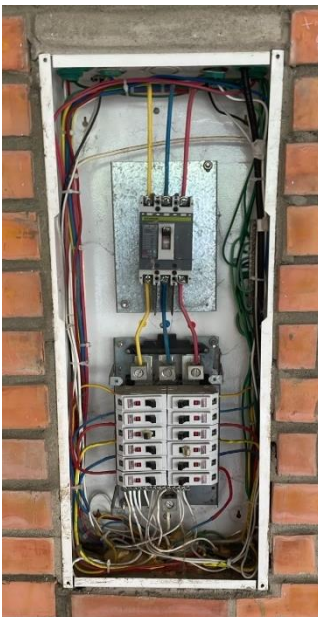
Estado interno inicial tablero #11
