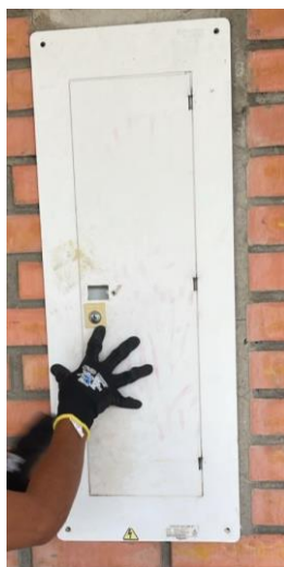
Estado interno inicial tablero #7
