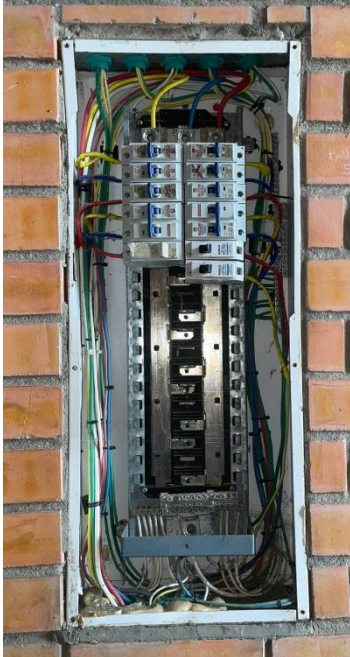
Estado interno inicial tablero #5
