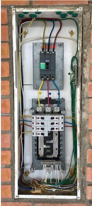
Estado interno inicial tablero #9
