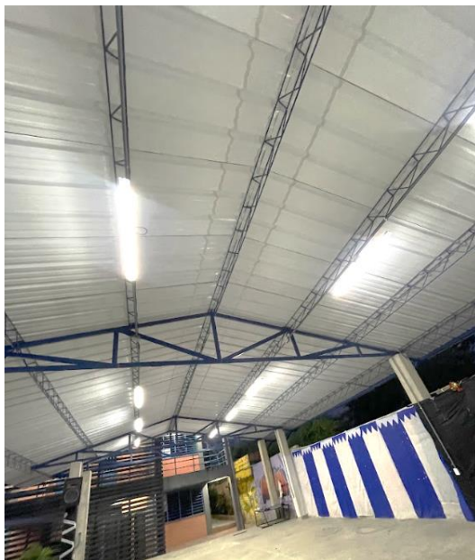
Evidencia de la iluminación instalada en auditorio.
