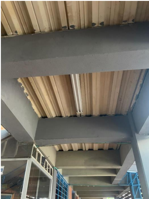
Estado inicial pasillo trasero del bloque.
