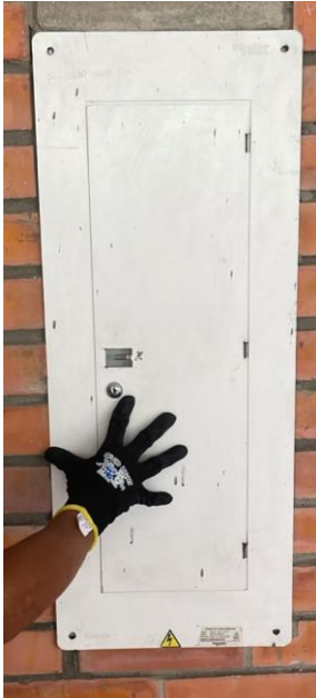
Estado interno final tablero #10
