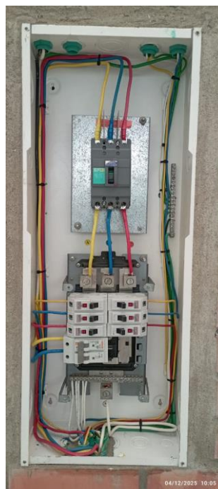
Estado interno final tablero #7
