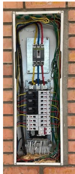
Estado interno inicial tablero #10
