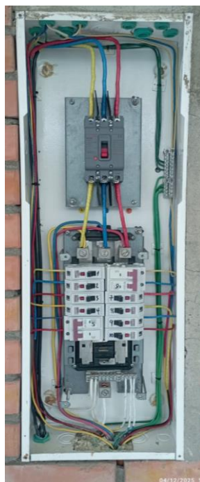
Estado interno final tablero #8
