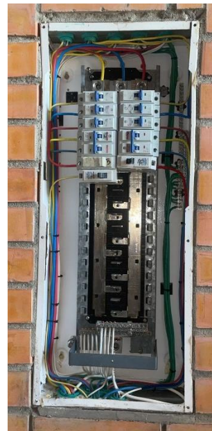
Estado interno final tablero #5
