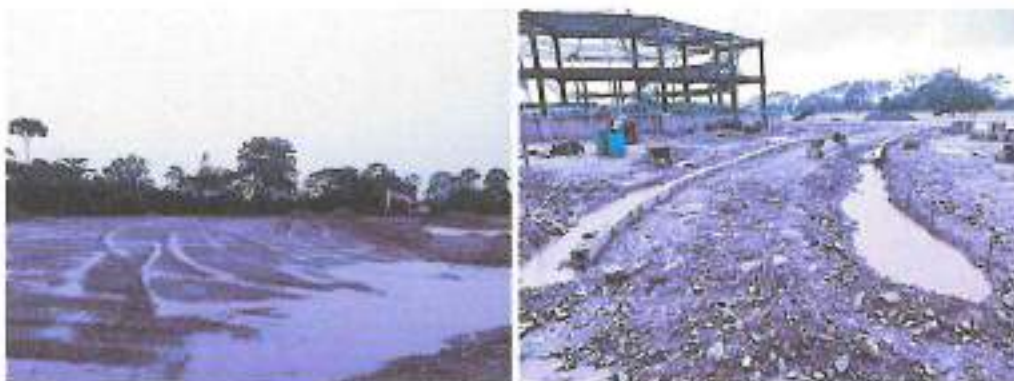
Afectaciones en frentes de obra por lluvias
