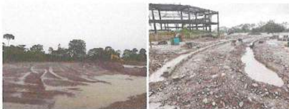
Afectaciones en frentes de obra por lluvias
