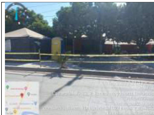
Fotografía señalización y baños portátiles y campamento
