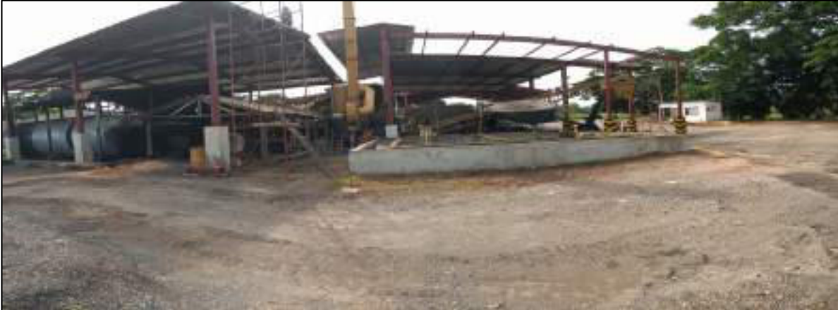
Imagen No 5: Planta de asfalto Mayorías. Consorcio Dumar Sofan
