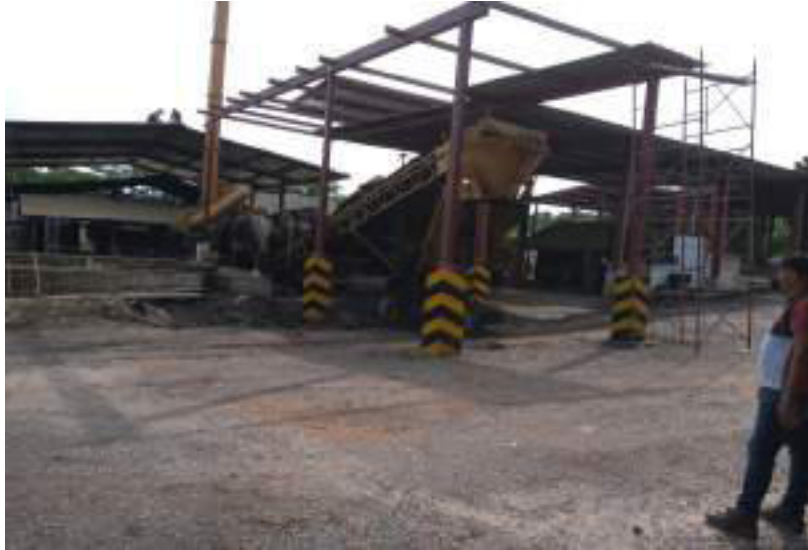
Imagen No 3: Planta de Asfalto
