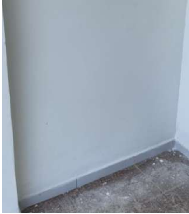
imagen 17. Instalación de guarda escoba en la zona de acceso al puesto de salud.
