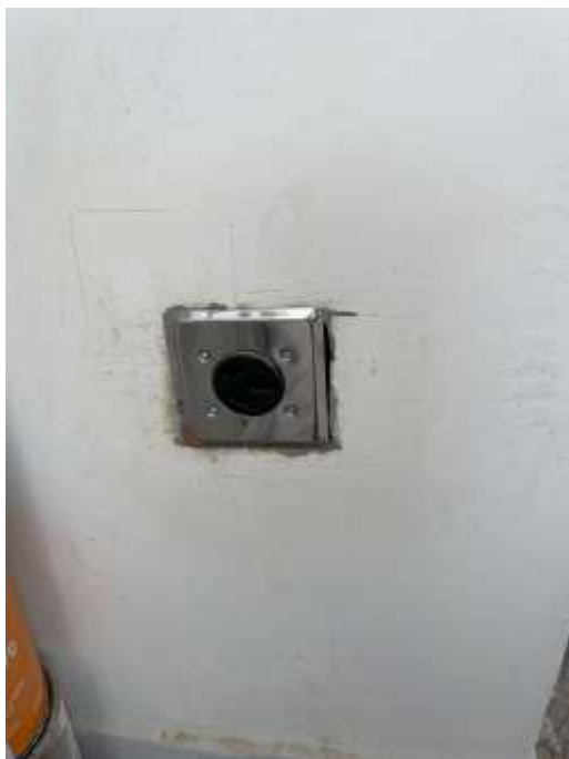
imagen 32. Punto de conexión para generador eléctrico externo.
