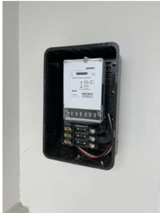
imagen 27. instalación de medidor de consumo de energía.
