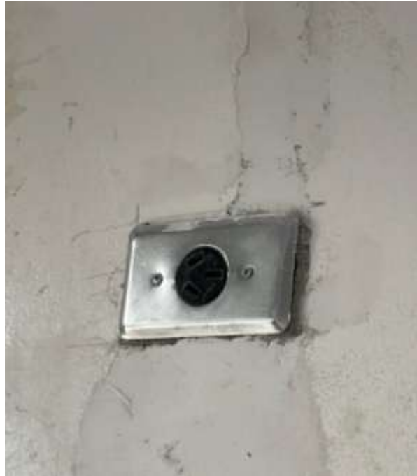
imagen 31. Punto de tomacorriente de 220V.
