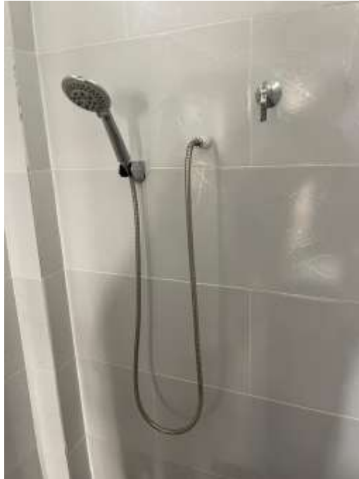
imagen 35. instalación de tele ducha y ducha tipo regadera.
