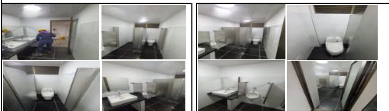
ASEO PARA ENTREGA BATERIA DE BAÑOS TORRE A PISO 5-4-3-2 // PUERTAS CERRADAS CON LLAVE ANTES DE USO DE LOS FUNCIONARIOS
