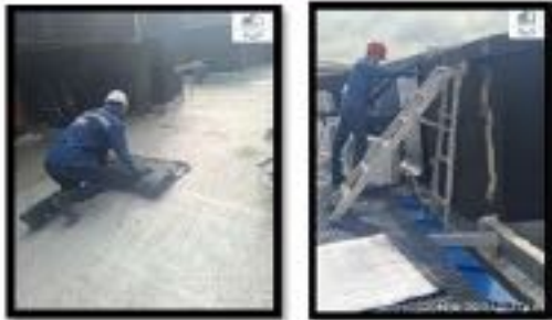
Instalación de mano
