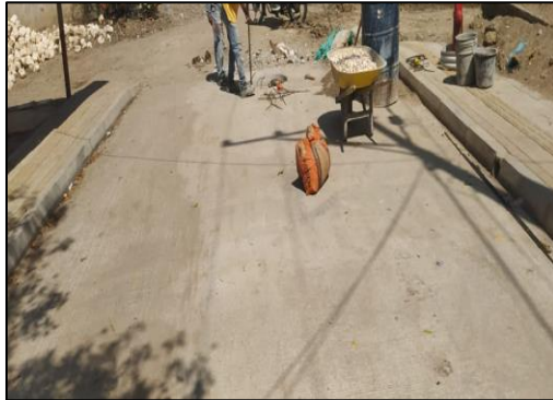
Verificación de mal acabado en pavimento
