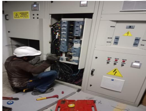
Instalaciones eléctricas Ascensor
