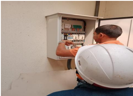
Instalaciones eléctricas Ascensor
