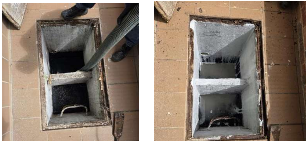
Caja de Inspección
