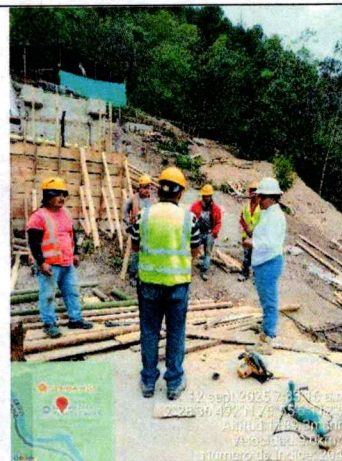
Ilustración 10. Inspección del Estado y Uso de los EPP del Personal de Obra
