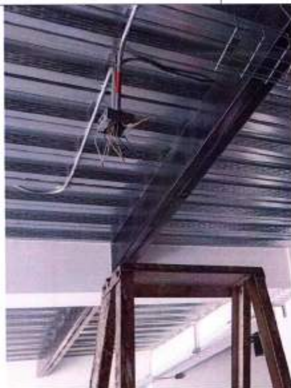
Fotografía 105 Salida para luminarias.
