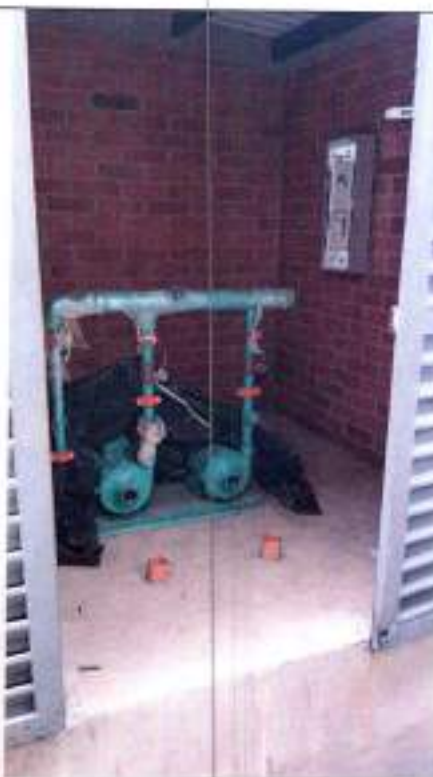
Fotografía 82 Bomba para sistema hidráulico de presión
