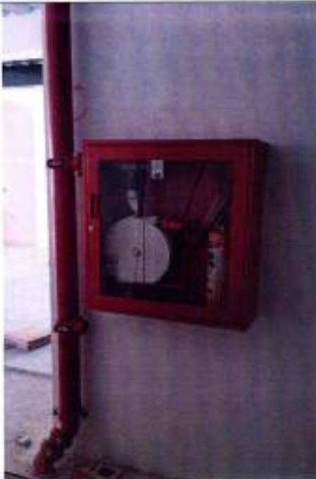
Fotografía 87 Gabinete contra incendios tipo II (0.77 x 0.77 x 0.24) según Norma NFPA, segundo piso
