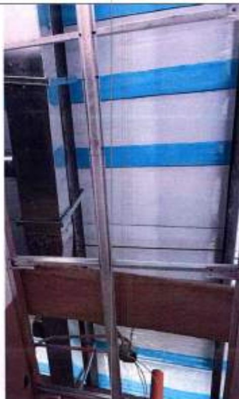
Fotografía 138 Ducto para extracción en baños
