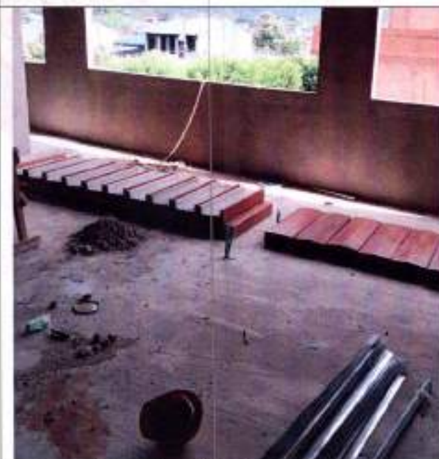
Fotografía 16 Alfajías en concreto
