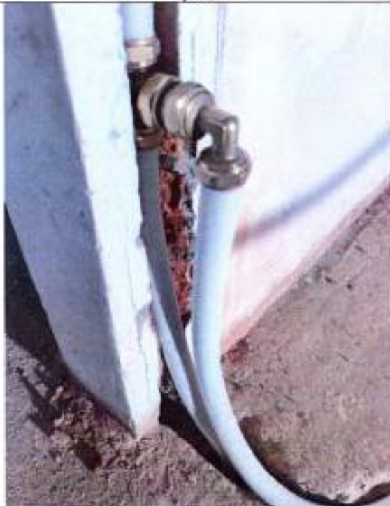
Fotografía 169 Derivación a conexión de segundo piso
