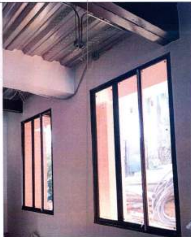
Fotografía 106 Salida para luminarias.
