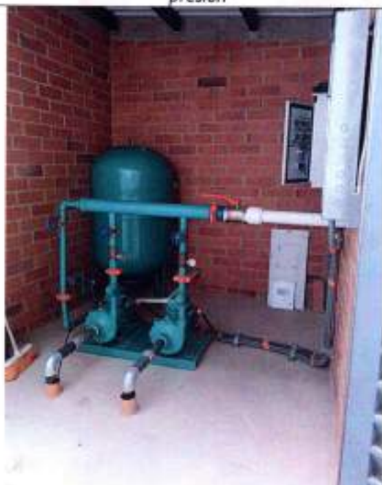
Fotografía 83 Bomba para sistema hidráulico de presión
