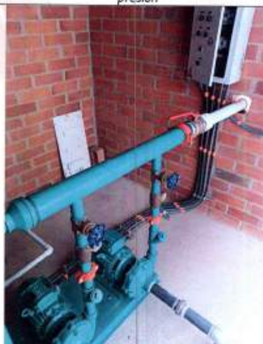
Fotografía 84 Bomba para sistema hidráulico de presión
