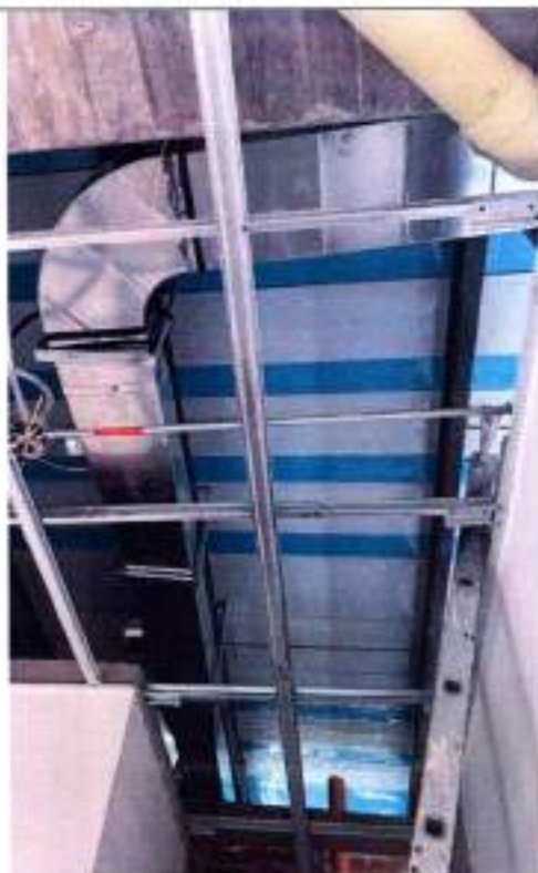
Fotografía 137 Ducto para extracción en baños
