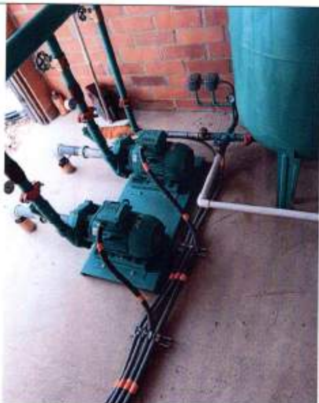
Fotografía 81 Bomba para sistema hidráulico de presión
