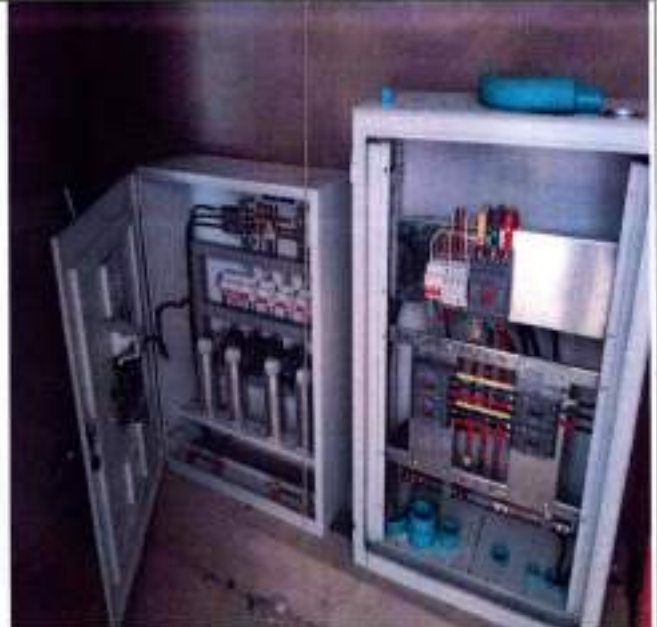
Fotografía 100 Tablero General TGAA y banco de condensadoras
