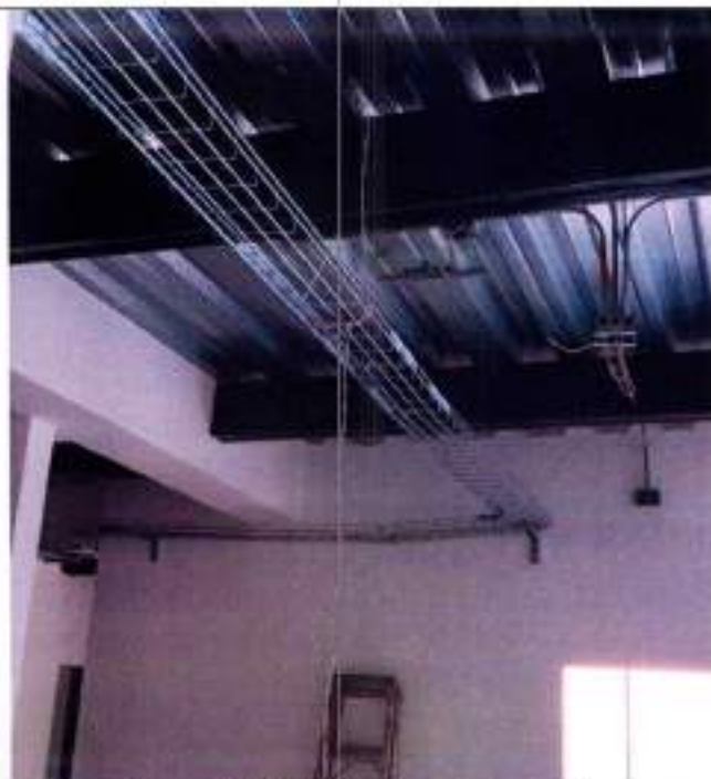
Fotografía 108 Salida para luminarias.
