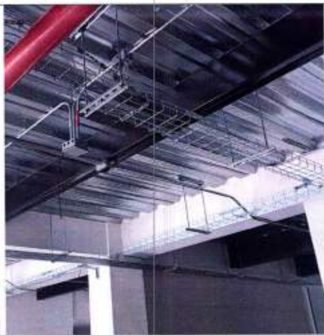
Fotografía 112 Salida para luminarias
