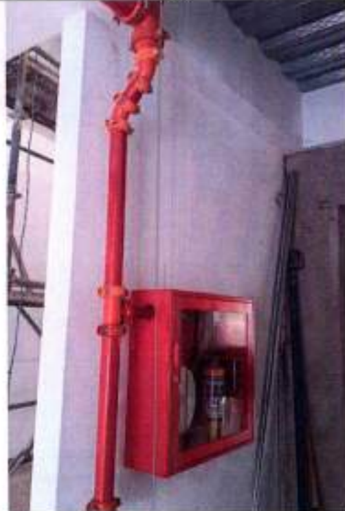
Fotografía 90 Gabinete contra incendios tipo II (0.77 x 0.77 x 0.24) según Norma NFPA, primer piso
