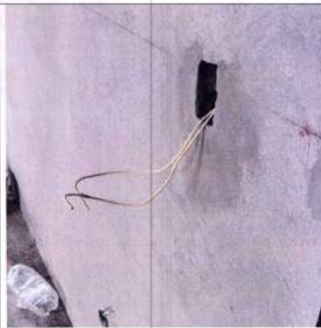
Fotografía 110 Salida para interruptores
