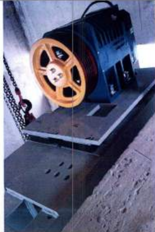
Fotografía 120 Cuarto de máquinas de ascensor
