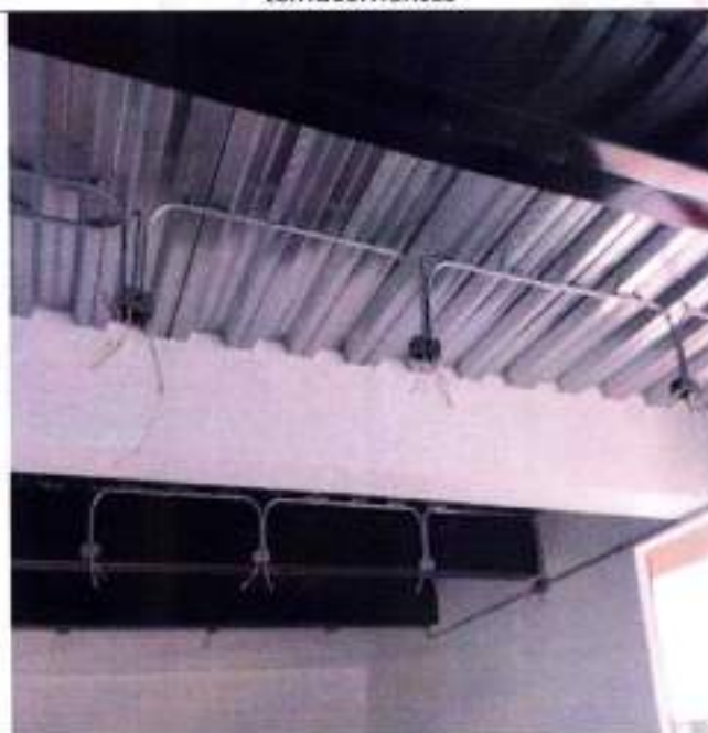
Fotografía 109 Salida para luminarias.
