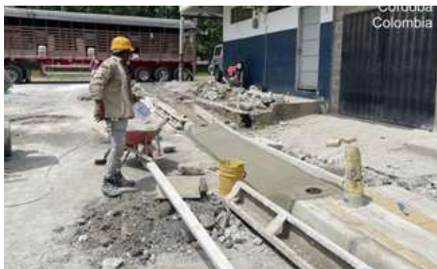
Pavimento – tramo Santa Barbara
