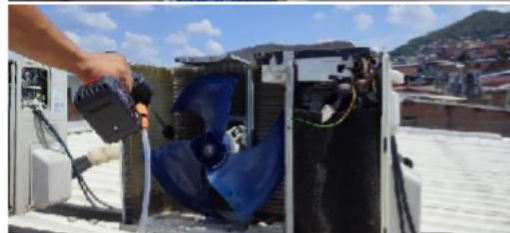
Imagen 4. Mantenimiento A.A. oficina 202
