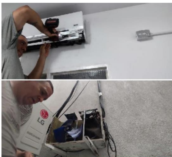
Imagen 12. Mantenimiento A.A oficina 107
