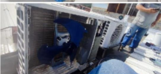
Imagen 7. Mantenimiento A.A oficina 205
