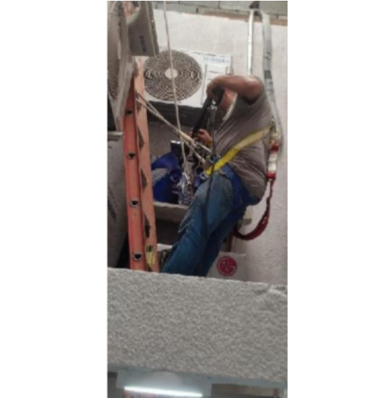
Imagen 10. Mantenimiento A.A oficina 105
