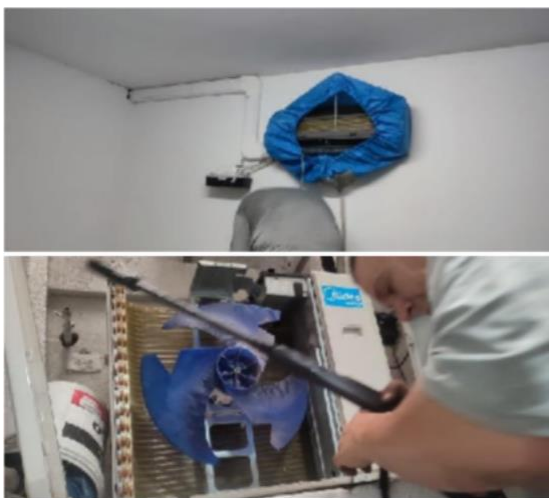
Imagen 11. Mantenimiento A.A oficina 106
