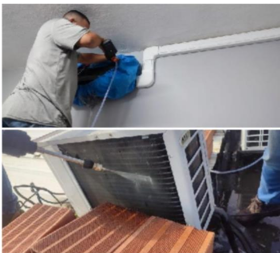
Imagen 13. Mantenimiento A.A oficina 109
