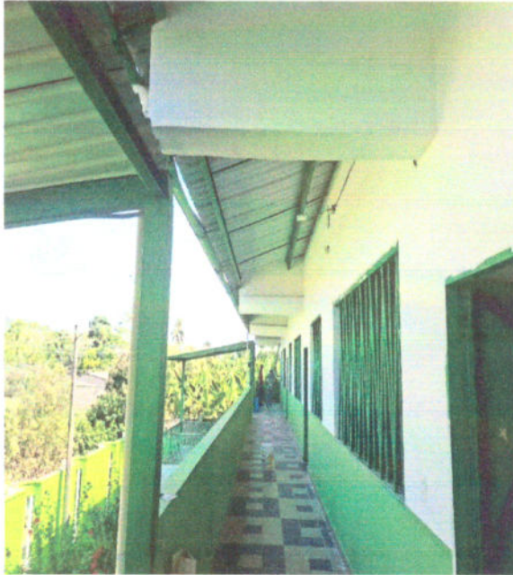
Fotografía 78. Estado inicial de Pasillo de bloque No.1
