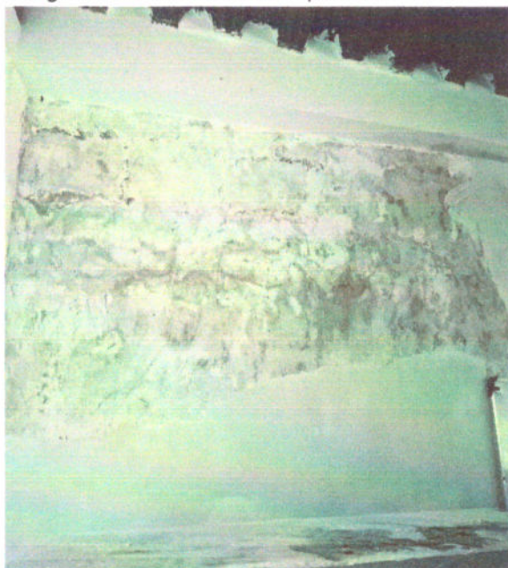
Fotografía 53. Area de muro con pintura deteriorada.
