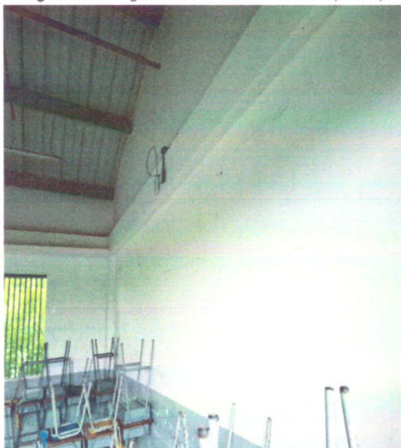
Fotografía 13. Registro inicial de estado de capa de pintura existente en paredes internas.
