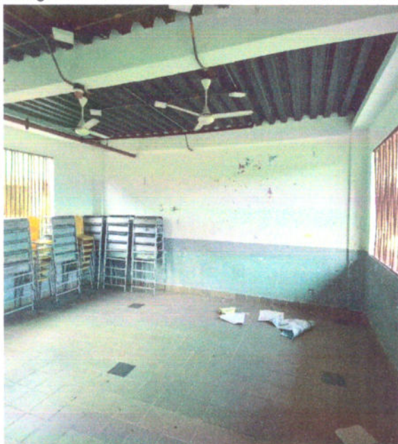
Fotografía 43. Estado inicial de instalaciones internas de Salón.
