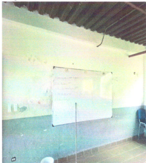
Fotografía 18. Estado inicial de paredes internas de aulas.
