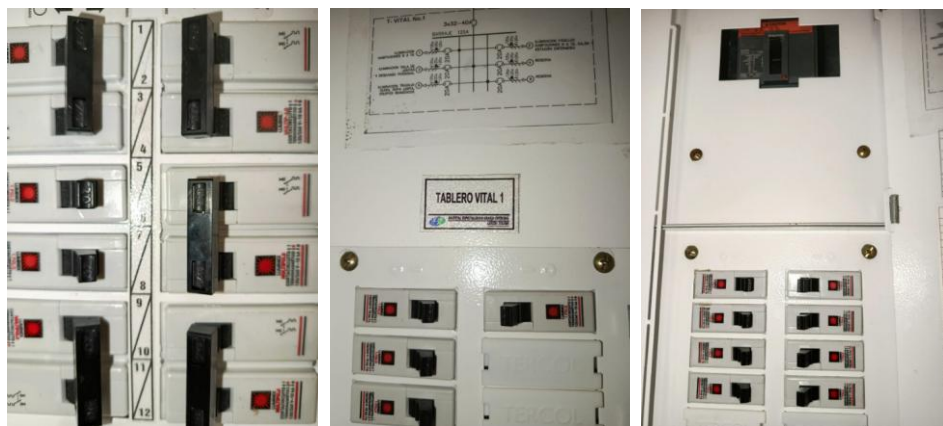
Señalización y marquillado tableros
