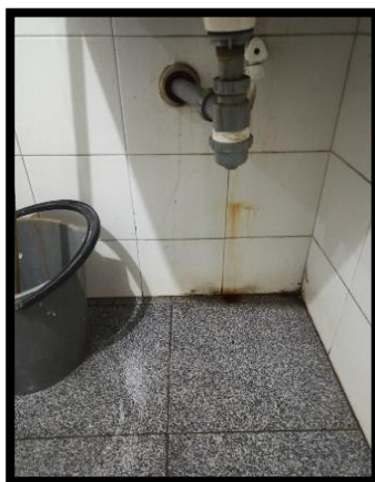
4 Lavamos con fuga de agua
