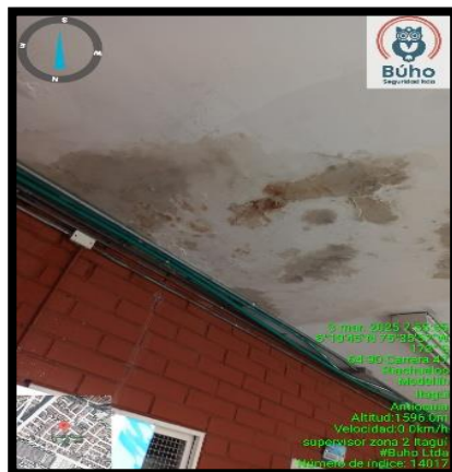
2 Humedad del primer piso
