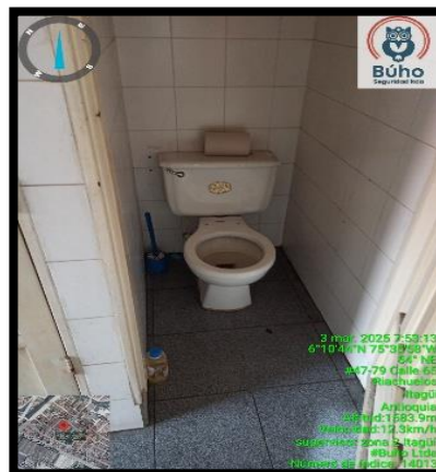
1 Baño del segundo piso desagüe averiado
