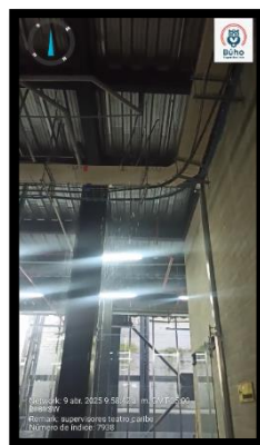
1.3. Tubo de acueducto dañado
