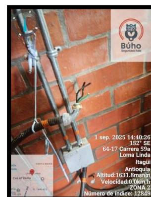
1.1. Cuarto de bombas cables rotos
