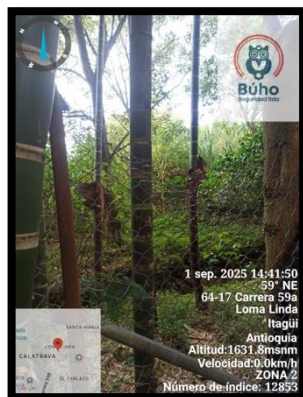
1.1. Cuarto de bombas reja perimetral dañada
