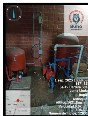
1.1. Cuarto de bombas elementos dejados por el presunto infractor
