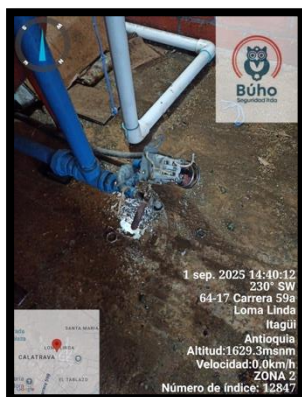
1.1. Cuarto de bombas tubo cortado
