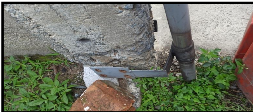
Taxiger primer piso, puerta dañada
