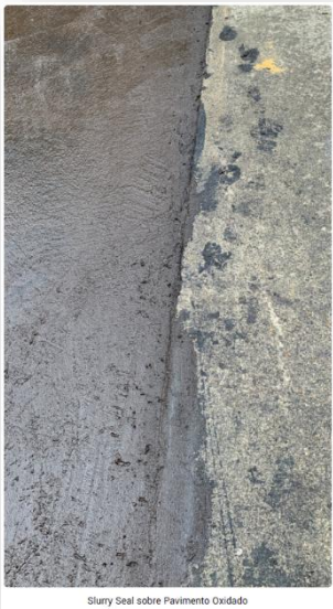
Slurry Seal sobre Pavimento Oxidado
