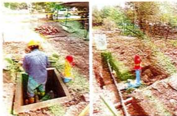
IMAGEN 113. HIDRANTE TIPO RESIDENCIAL Ø=3" EN EXTREMO BRIDADO 2 SALIDAS DE 2 1/2". BARRIL SECO. SUMINISTRO E INSTAL.
