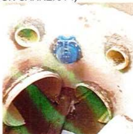
IMAGEN 16. VÁLVULA CHAPAleta HIERRO DÚCTIL 12", SUMINISTRO E INSTALACIÓN.
