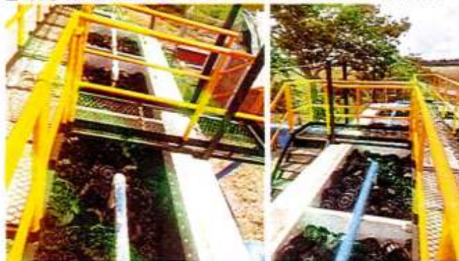
IMAGEN 73. RELLENO PLÁSTICO TIPO BIOPACK TAS COLOR NEGRO, PARA FILTRO PERCOLADOR. SUMINISTRO E INSTAL.
