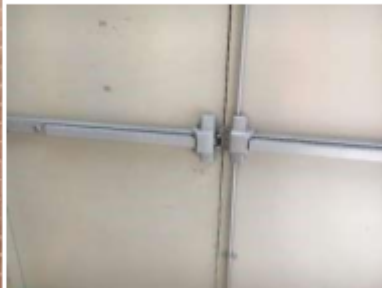
Fotografía puertas de Emergencias
