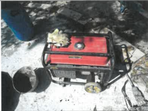
FOTO No. 100. Se revisó y verificó el uso de la planta eléctrica en los parques URBANIZACIÓN LA ESTANCIA (19-039), (19-150) y PARQUE URBANIZACIÓN CANDELARIA LA NUEVA II SECTOR 1ª ETAPA (19-479)
