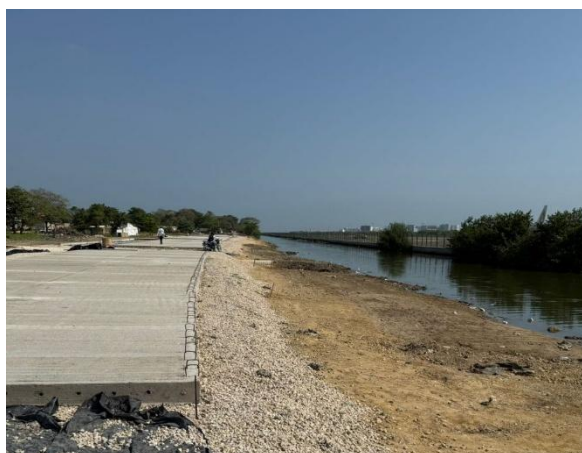
Ilustración 2 Talud de la vía cercano a cuerpo de agua, frente perimetral
