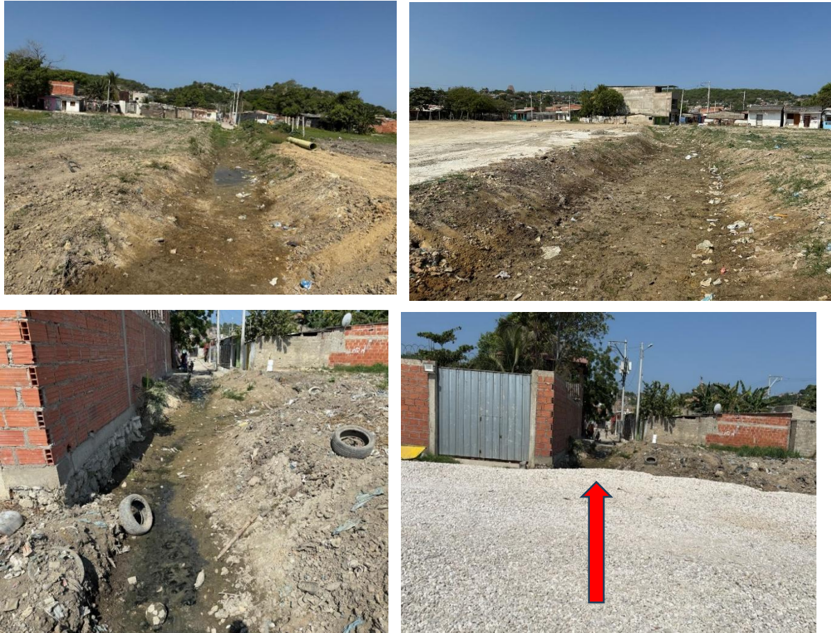
Ilustración 3 Escorrentías de áreas adyacentes a la vía, frente perimetral
