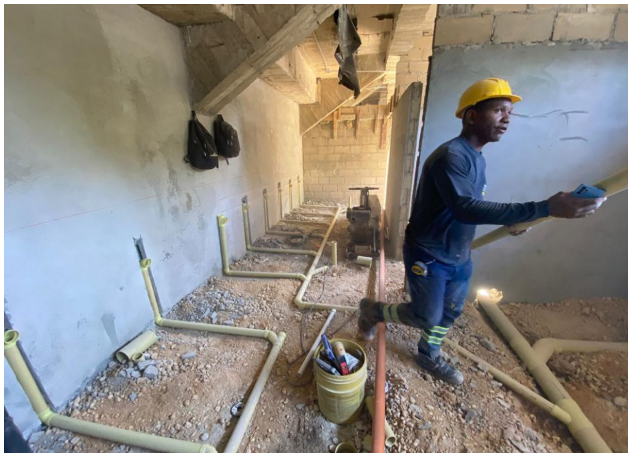
Ilustración 33. Instalaciones sanitarias baños graderías de softbol
