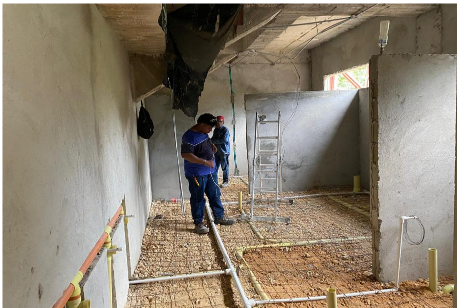
Ilustración 34. Instalaciones hidráulicas baños graderías de softbol
