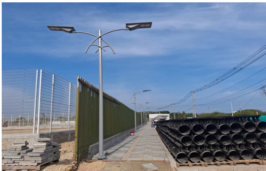
Ilustración 64. Instalaciones de lámparas solares
