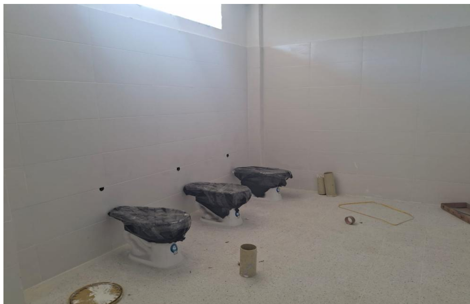
Ilustración 51. Instalaciones sanitarios baños cancha futbol 11
