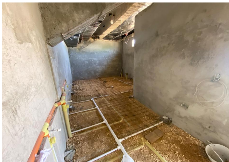
Ilustración 34. Instalaciones hidráulicas baños graderías de fútbol
