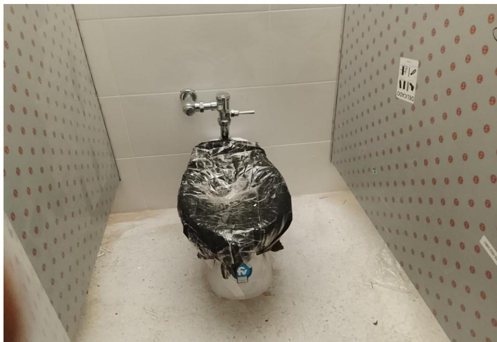
Ilustración 45. Instalaciones sanitarios y fluxómetros baños cancha futbol 11
