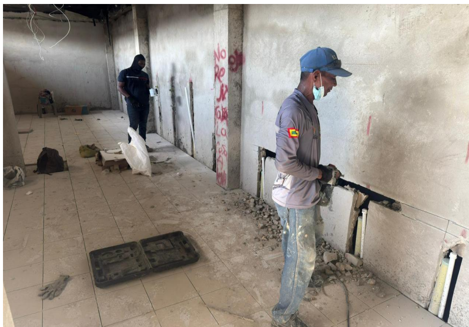
Ilustración 49. Instalaciones hidrosanitarias baños y camerinos cancha futbol 9
