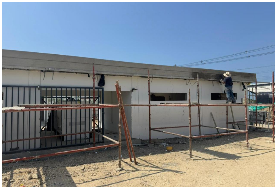
Ilustración 43. Acabados cuarto técnico
