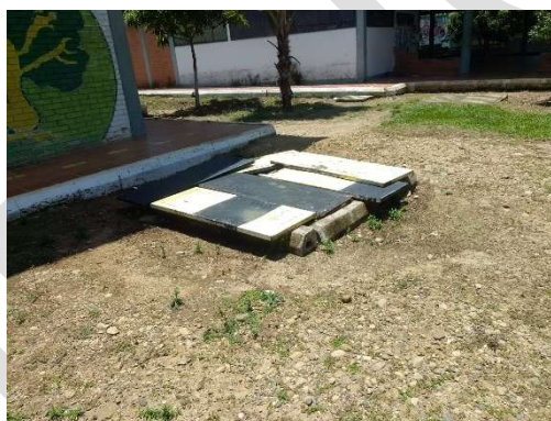
Imagen No. 06. Trampa de grasas existente.
