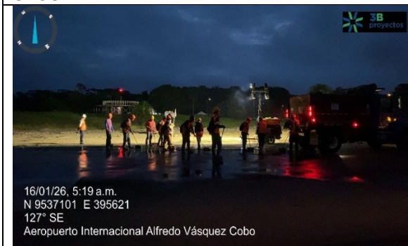
Fotografía No. 9 CANALIZACIONES Y CABLEADO DE AYUDAS VISUALES
