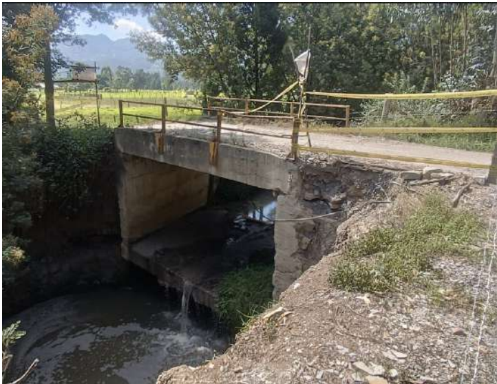
Fotografía 8. Estado actual cauce del río Susa sobre el puente vehicular. Fuente propia.
