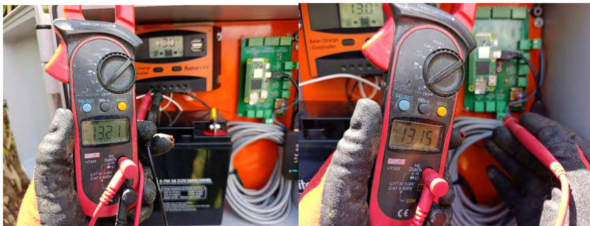
Ilustración 6: Medición de voltaje de batería 13.21V y estado de batería ok
