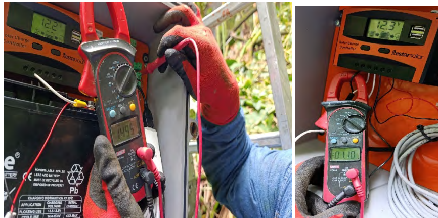
Ilustración 6: Verificación de voltaje de paneles solares y estado de batería ok.
